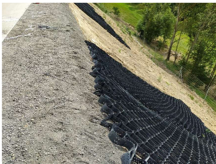
Obrázek 43: Chybně provedená instalace geobuňek (Kozák, 2021)
