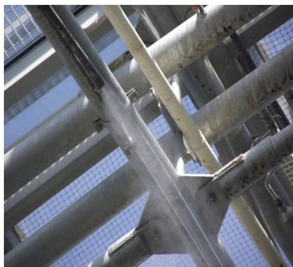
Obr. č. 52. Rosení ze stropní konstrukce
