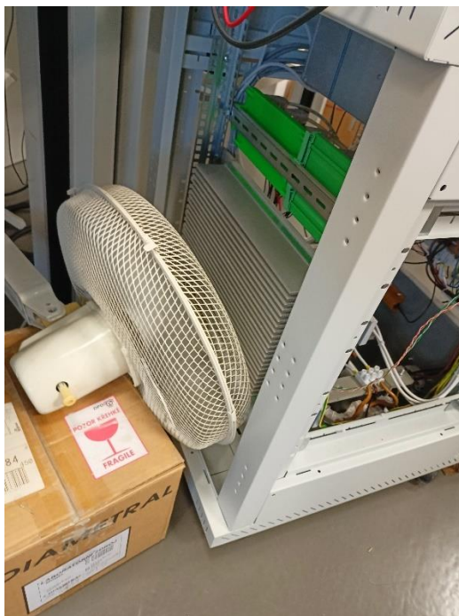
Obrázek 57 Chlazení měniče při zatěžovací zkoušce
