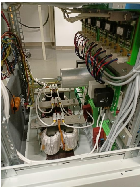
Obrázek 29 Pohled dovnitř měniče
