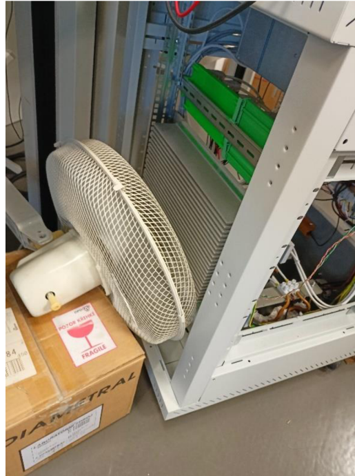
Obrázek 57 Chlazení měniče při zatěžovací zkoušce
