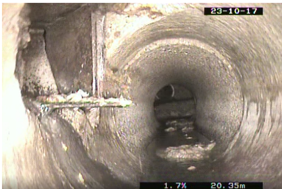
Obr. 5.8: Porucha 4 – přesazená kanalizační přípojka
