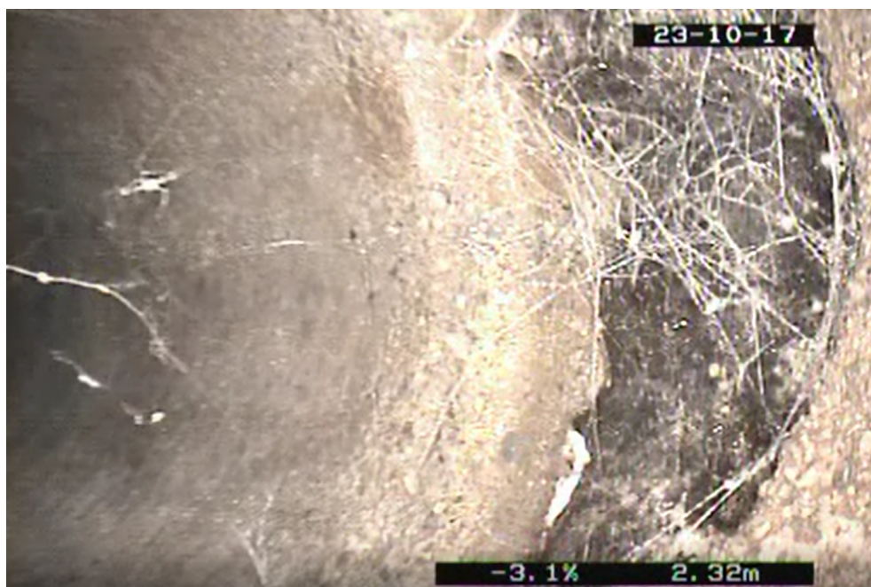
Obr. 5.6: Porucha 2 – Vypadlý střep
