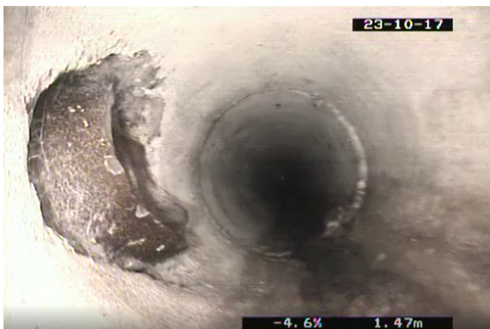
Obr. 5.5: Porucha 1 – přesazená kanalizační přípojka
