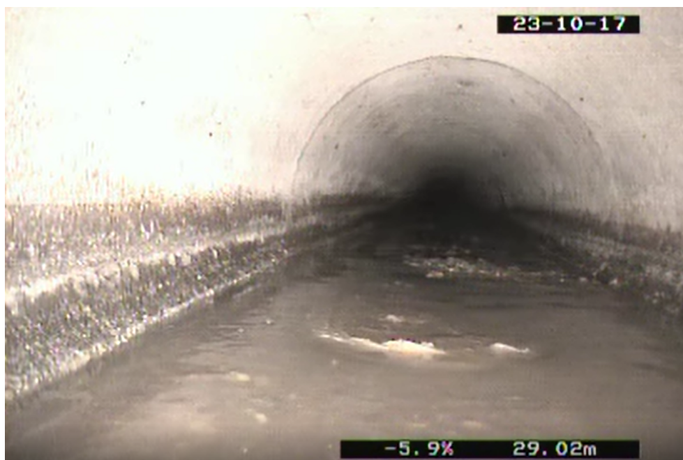
Obr. 5.9: Porucha 5 – vzdutá hladina
