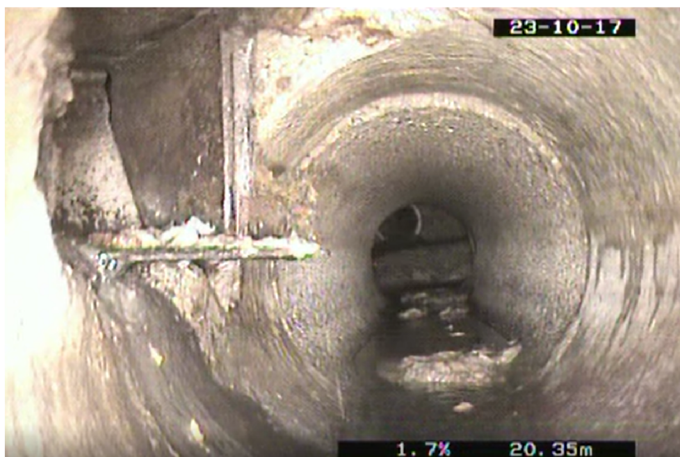
Obr. 5.8: Porucha 4 – přesazená kanalizační přípojka
