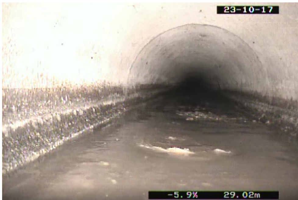
Obr. 5.9: Porucha 5 – vzdutá hladina
