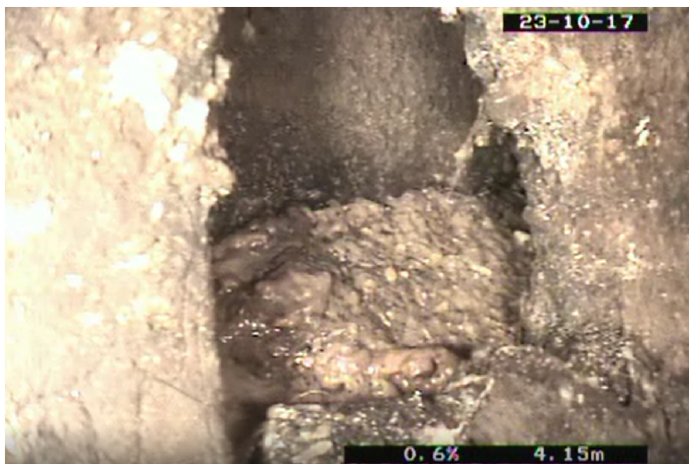
Obr. 5.7: Porucha 3 – Vypadlý střeš
