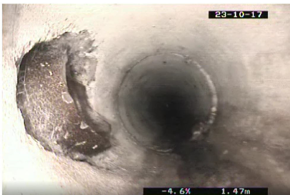
Obr. 5.5: Porucha 1 – přesazená kanalizační přípojka
