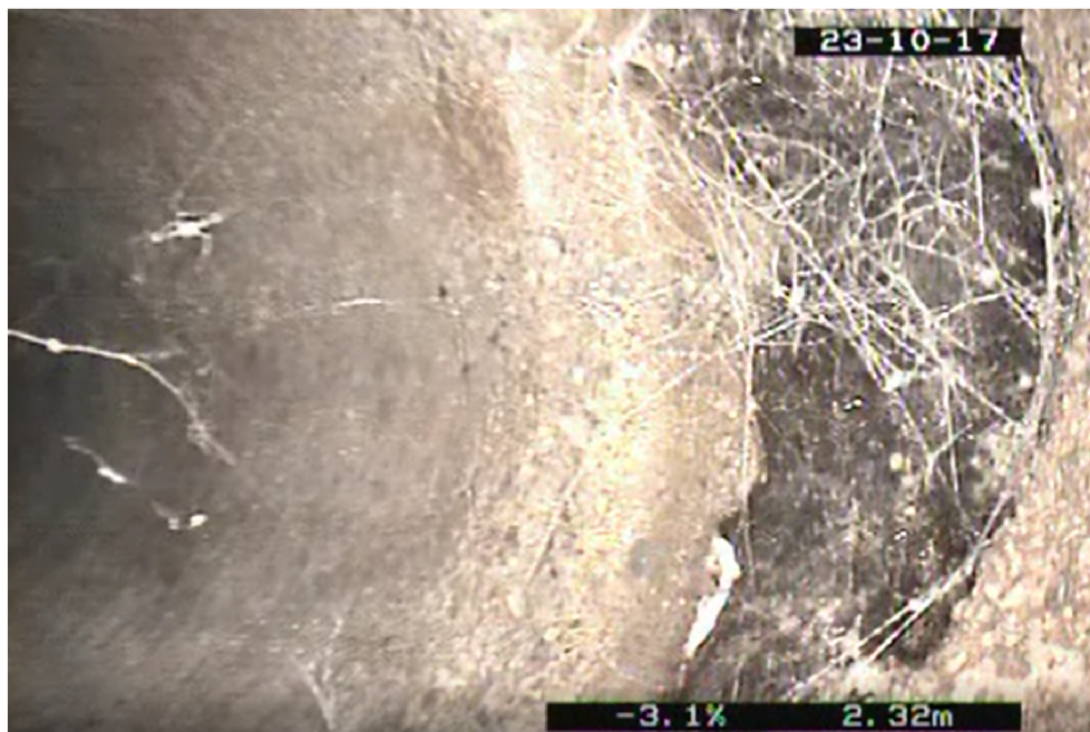
Obr. 5.6: Porucha 2 – Vypadlý střep
