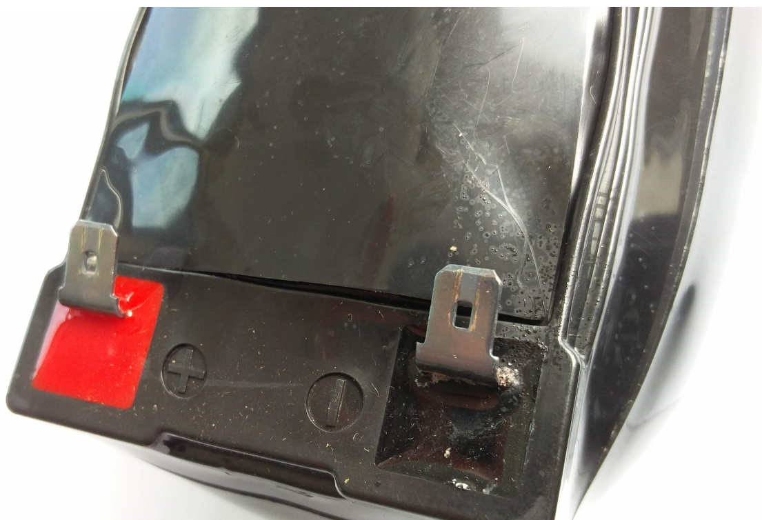
Obr. 2.20: Vyžhání vývodového pólu vysokou teplotou, nadměrný tlak v rámci akumulátoru zapříčinil únik elektrolytu mimo nádobu akumulátoru.
