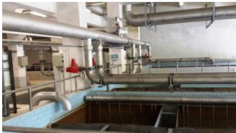
Obrázek 9:Armaturní prostory pod filtry
