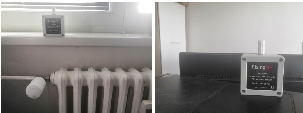
Obr. 7.3: Zariadenia monitorujúce a ovládajúce teplotu miestnosti.
