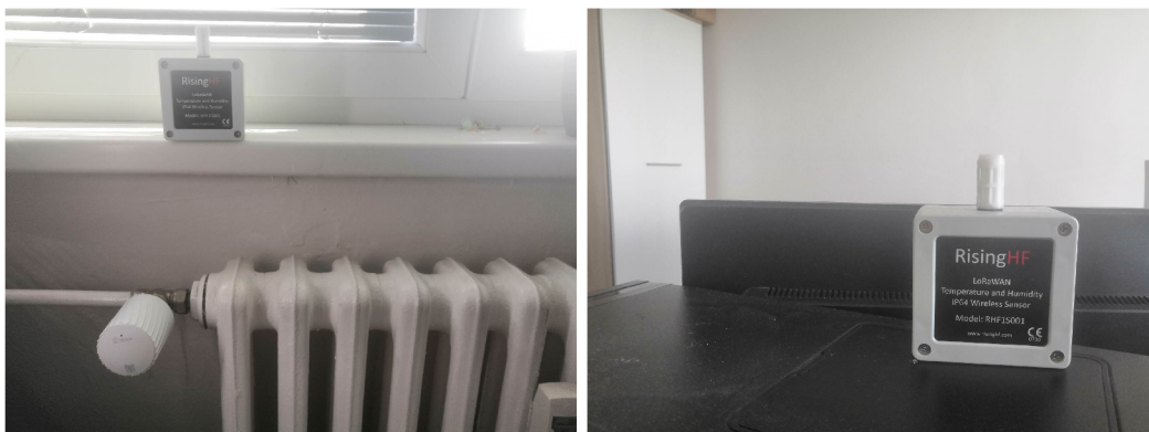
Obr. 7.3: Zariadenia monitorujúce a ovládajúce teplotu miestnosti.
