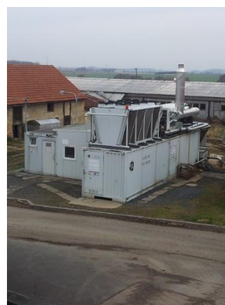
Obrázek 13 – budova, ve které se nachází řídicí jednotka a kogenerační jednotka
