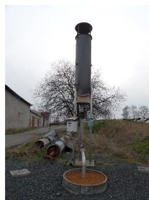
Obrázek 9 – hořák zbytkového plynu
