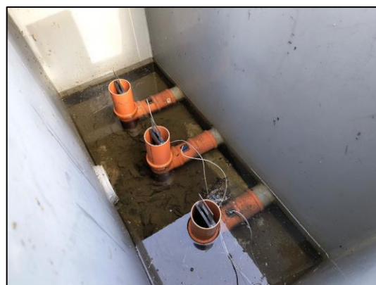
Foto. 2: pohled do rozdělovací šachty
