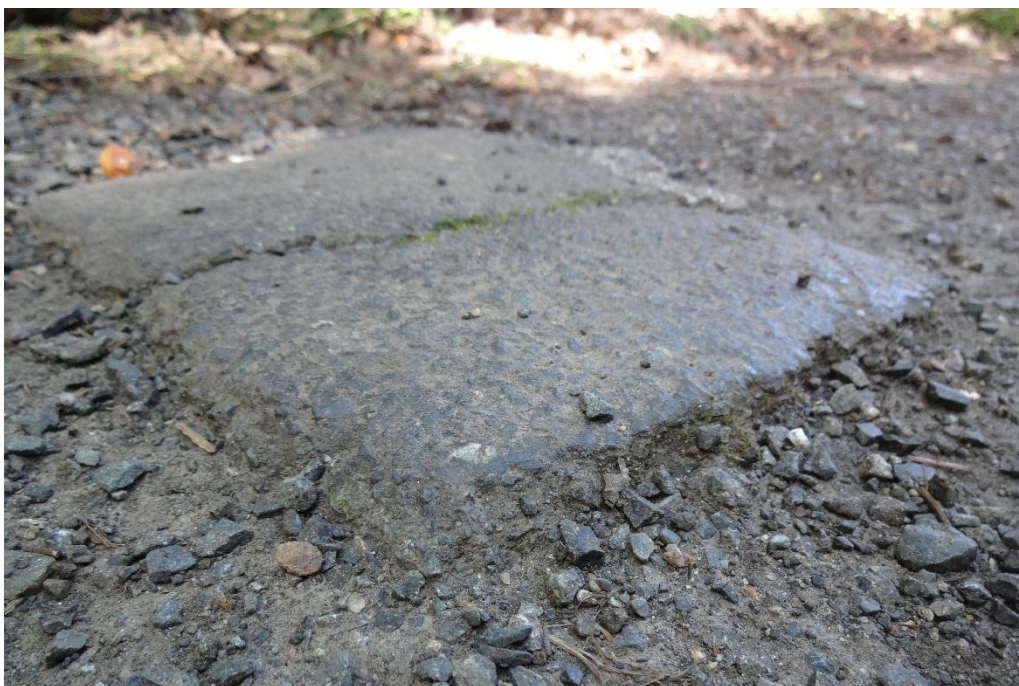
Obr. 36: Vyčnívající kostky z asfaltového recyklátu
