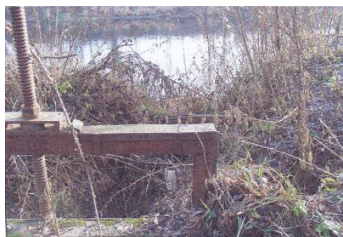
Obr. 16 – Nefunkční náпустní objekt [10]
