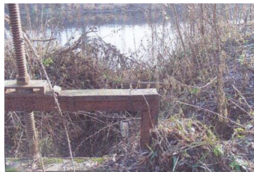
Obr. 16 – Nefunkční náпустní objekt [10]
