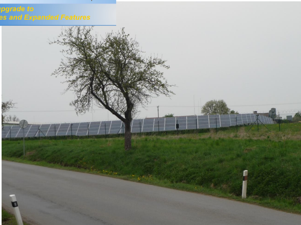
Foto 3 Pln funk ní fotovoltaická elektrárna, umíst ní je u Bechyn , ve sm ru na Týn nad Vltavou
