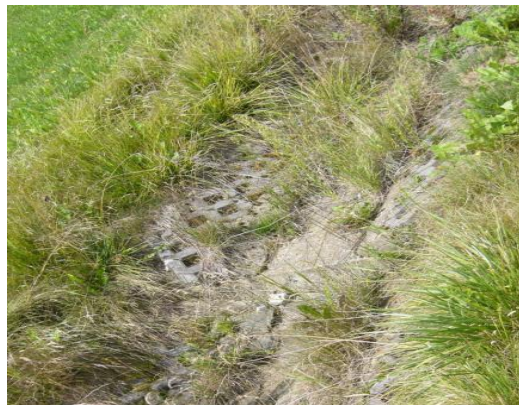
Obr. 35: Odvodňovací příkop se stupněm
