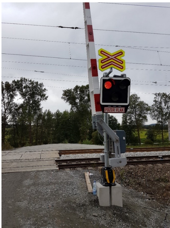
Obr. 1.3 Přejezdové zabezpečovací zařízení
