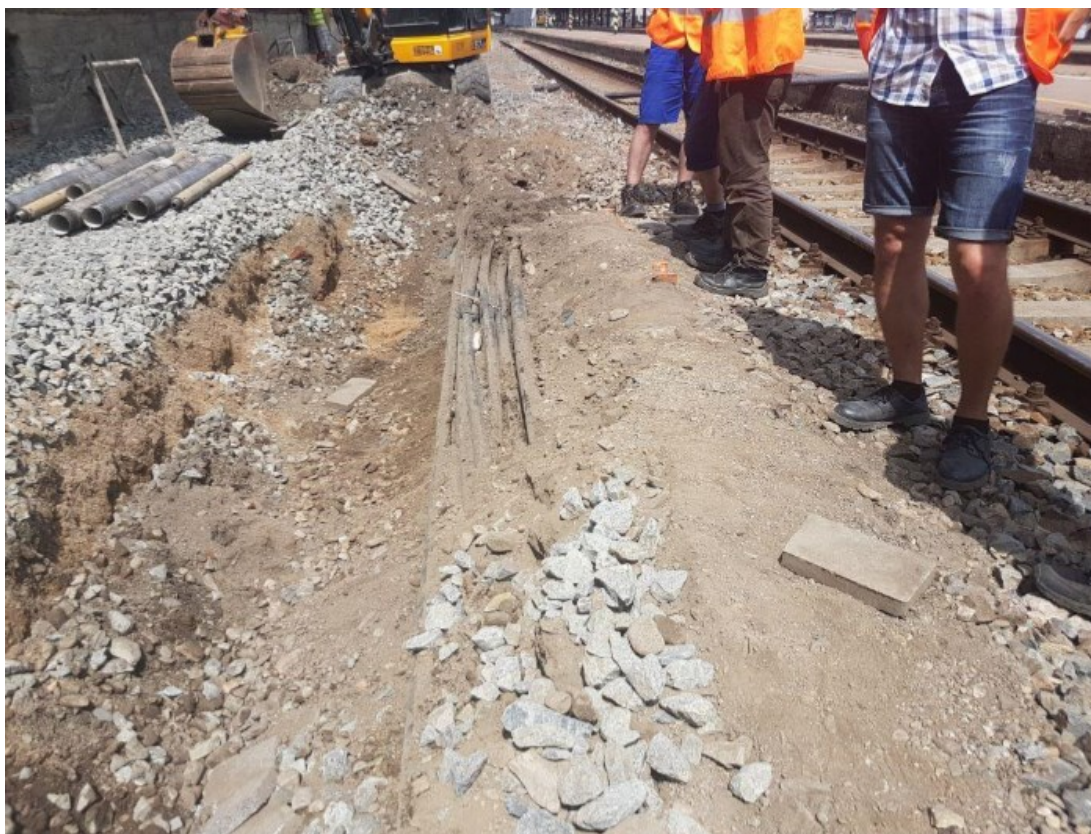
Obr. 4.1 Poškozené kabely zabezpečovacího zařízení
