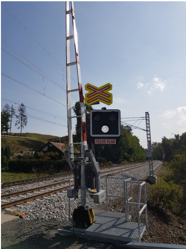
Obr. 1.4 Přejezdové zabezpečovací zařízení
