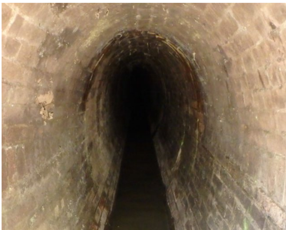
Obr. č. 35: Pohled do stoky v ulici Milosrdných od Š03SK směrem po toku (Sismilich, 2018).
