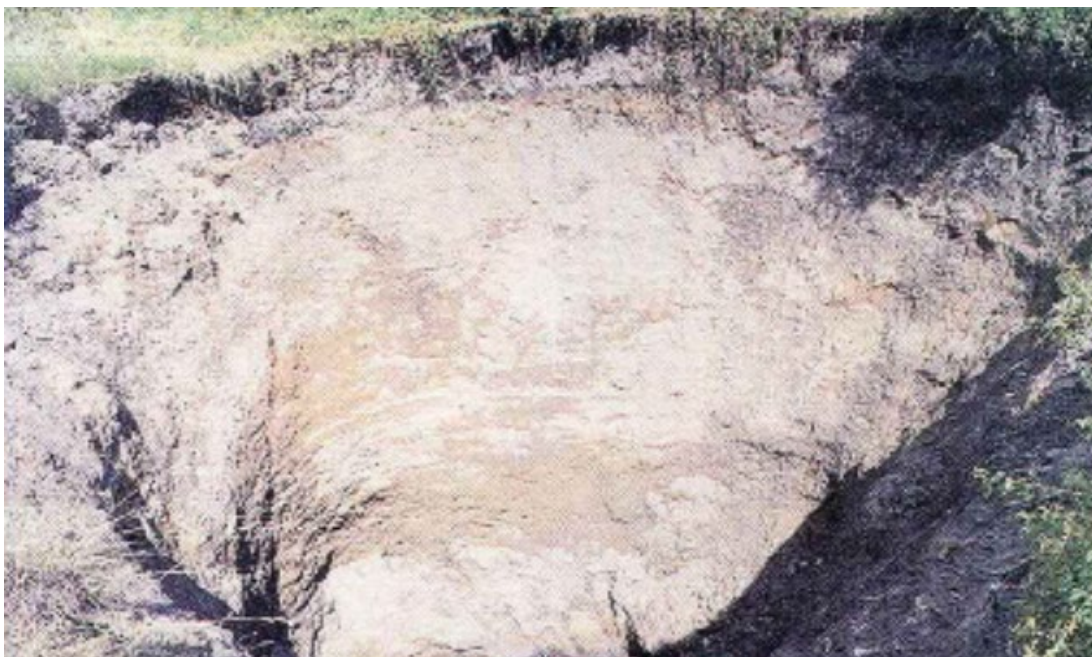
Obr. č. 14: Propad nad kanalizací v blízkosti tramvajové zastávky Trojská (Řehoř, 2011).
