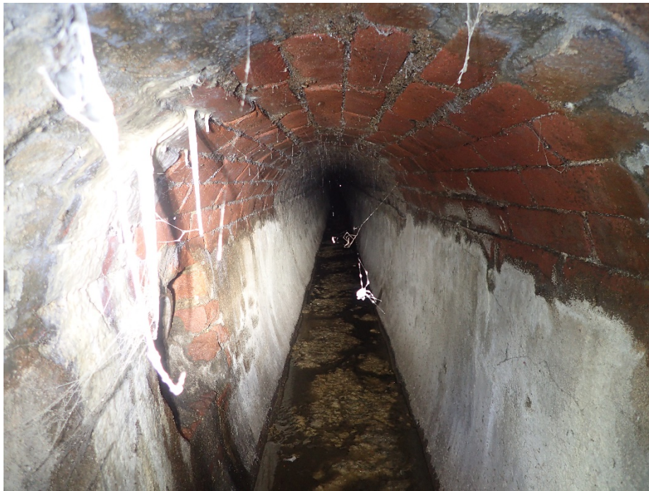
Obr. č. 20: Pohled do stoky v ulici Šumavská od šachty Š61 po toku (Sismilich, 2019).
