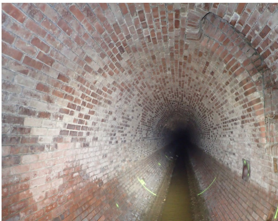
Obr. č. 25: Pohled do stoky v ulici U Seřadiště od Š06 po toku (Sismilich, 2019).
