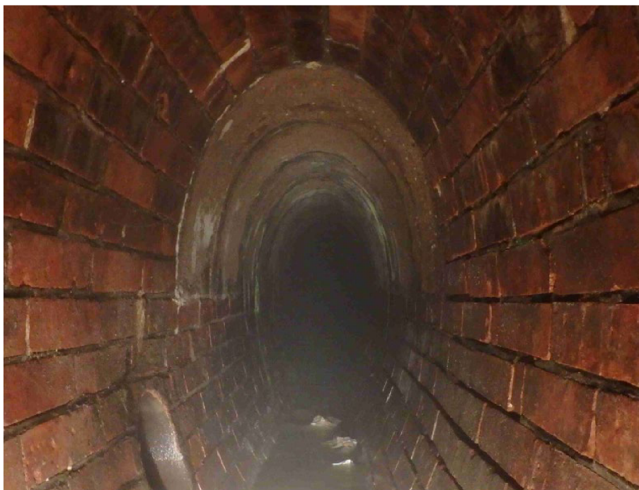
Obr. č. 31: Pohled do stoky v ulici Seifertova od Š23BV směrem po toku (Sismilich, 2018).
