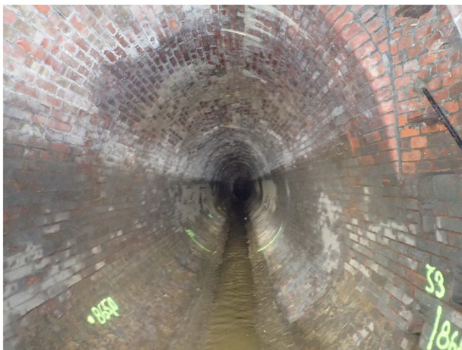
Obr. č. 26: Pohled do stoky v ulici U Seřadiště od Š03 po toku (Sismilich, 2019).
