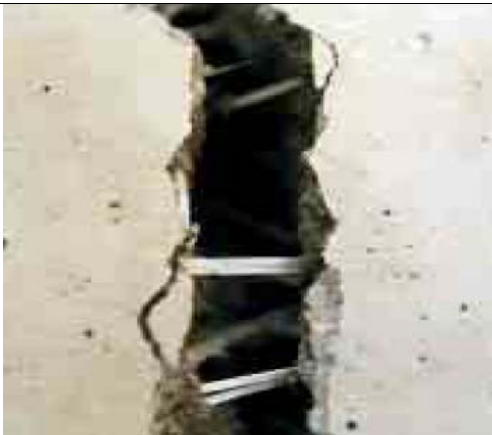
Obr. 1.20 Detail magistrální trhliny v trámci vyztuženého skelnými vlákny, které plní funkci rozptýlené výztuže
