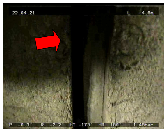
Obrázek 63 BAJ- Posunutý trubní spoj ve staničení 4,8 m, úsek Š1 AF - Š2 AF
