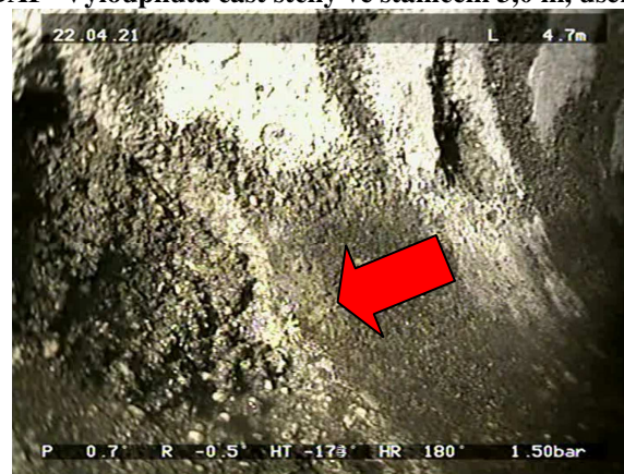
Obrázek 74 BAF- Odlomená část stěny ve staničení 4.7 m, úsek Š5 AF- Š6 AF
