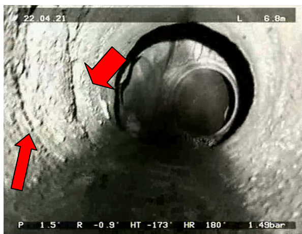
Obrázek 66 BAF- Odlomená část stěny vlivem koroze ve staničení 7,0 m, úsek Š2 AF- Š3 AF
