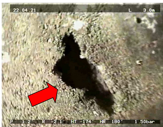
Obrázek 73 BAF- Vyloupaná část stěny ve staničení 3,0 m, úsek Š5 AF- Š6 AF
