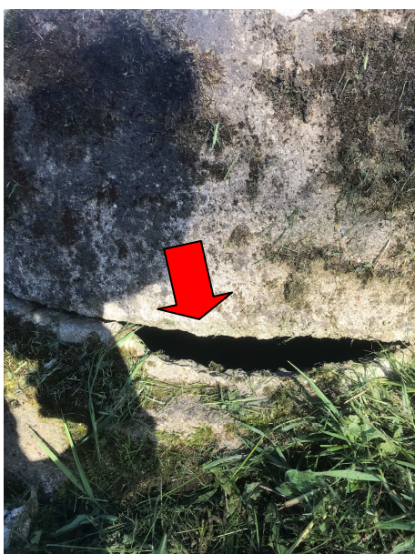
Obrázek 55 Š2 A – Destrukce stěny stoky
