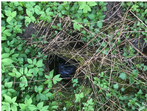
Obrázek 60 Destrukce potrubí na stoce AL
