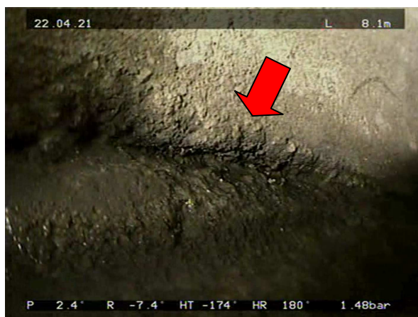
Obrázek 62 BAF- Chybějící část stěny ve staničení 8,1 m, úsek Š1AF- Š2 AF
