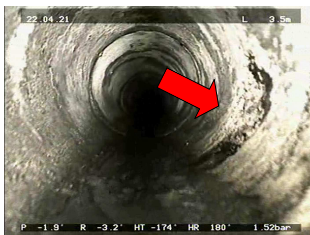
Obrázek 72 BAF- Vyloupenutá část stěny ve staničení 3,5 m, úsek Š4 AF – Š5 AF
