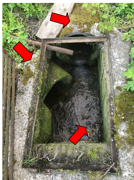
Obrázek 56 Š1 AL – Mělce umístěná šachta, odhalená přívodní potrubí, vadné napojení stok, překážky v šachtě
