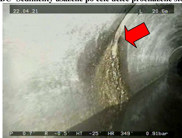
Obrázek 78 BAJ, BBF, BBB- Pronikající voda přes posunutý spoj s vytvářením inkrust ve stan. 21,0m
