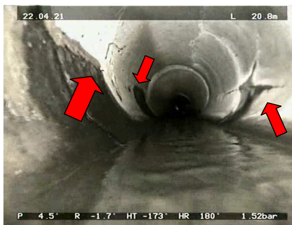
Obrázek 80 BAB, BBF- Infiltrace vody do kanalizace přes podélné praskliny po levé i pravé straně potrubí, úsek Š14 A- Š15 A
