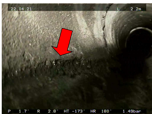
Obrázek 67 BAF- Zvýšená drsnost stěny ve staničení 2,2 m, úsek Š2 AF - Š3 AF
