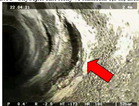
Obrázek 70 BAF- Vyloupaná část stěny ve staničení 2,4 m, úsek Š4 AF- Š5 AF
