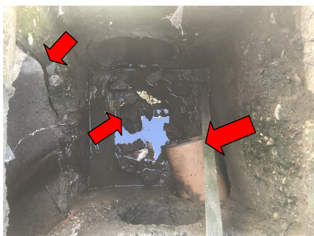
Obrázek 58 Předšazená přípojka, překážky v šachtě, poškození povrchu, netěsnosti
