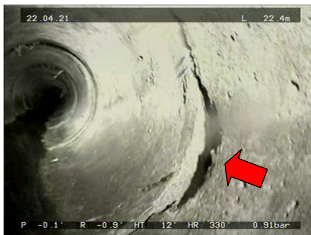
Obrázek 61 BAF- Chybějící část stěny ve staničení 22,4 m, úsek Š1 AN-Š2 A
