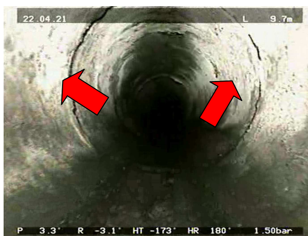
Obrázek 76 BAF- Příznaky koroze ve staničení 8.2 m do 31,1 m, úsek Š5 AF- Š6 AF
