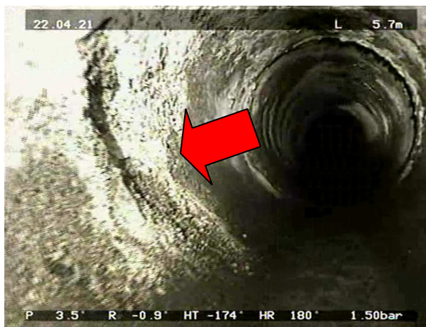
Obrázek 75 BAF- Odlomená část stěny ve staničení 5,7 m, úsek Š5 AF- Š6 AF
