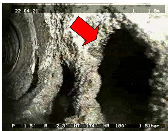
Obrázek 69 BAC- Chybějící část stěny ve staničení 1,8 m, úsek Š4 AF- Š5 AF
