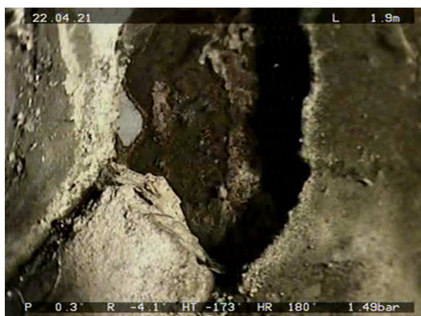
Obrázek 65 BAC- Chybějící část stěny ve staničení 1,9 m, úsek Š2 AF- Š3 AF
