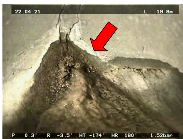
Obrázek 79 BAB, BBF- Infiltrace vody do kanalizace přes prasklinu ve staničení 19,8 m,
