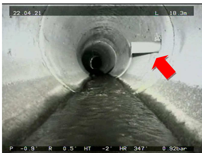
Obrázek 68 Vadně napojená přípojka ve staničení 20,4 m na úseku Š8 A – Š10 A
