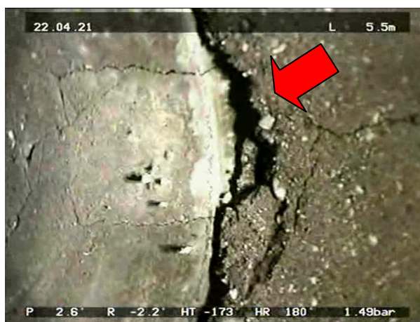
Obrázek 64 BAB- Vypadlá část stěny vlivem trhlin ve staničení 5,5 m, úsek Š2 AF- Š3 AF
