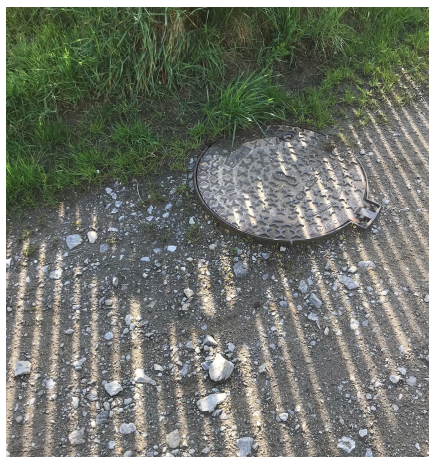
Obrázek 35 Ukázka kovového poklopu na Š8 AA
