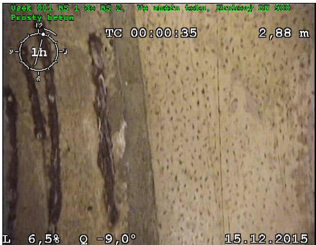
Obrázek 8.3 – Úsek Š1 – Š2, horní polovina potrubí, celý úsek, obnažená výztuž - BAFHC
