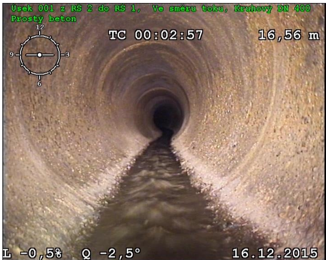
Obrázek 8.13 – Úsek Š1 – Š2, koroze materiálu po celém obvodu, celý úsek – BAFCB
