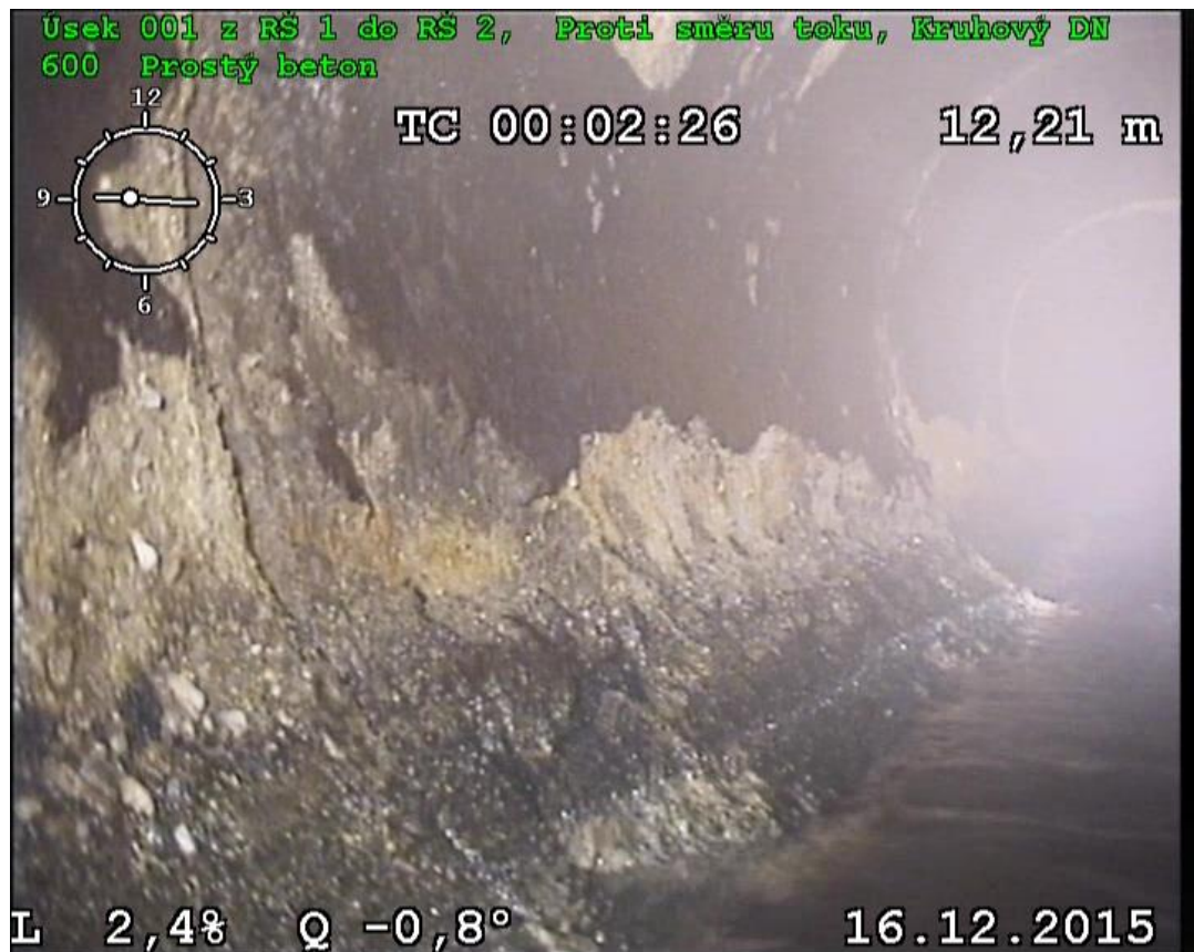
Obrázek 8.6 – Úsek Š1 – Š2, značné mechanické opotřebení ve styku s hladinou, celý úsek - BAFEA
