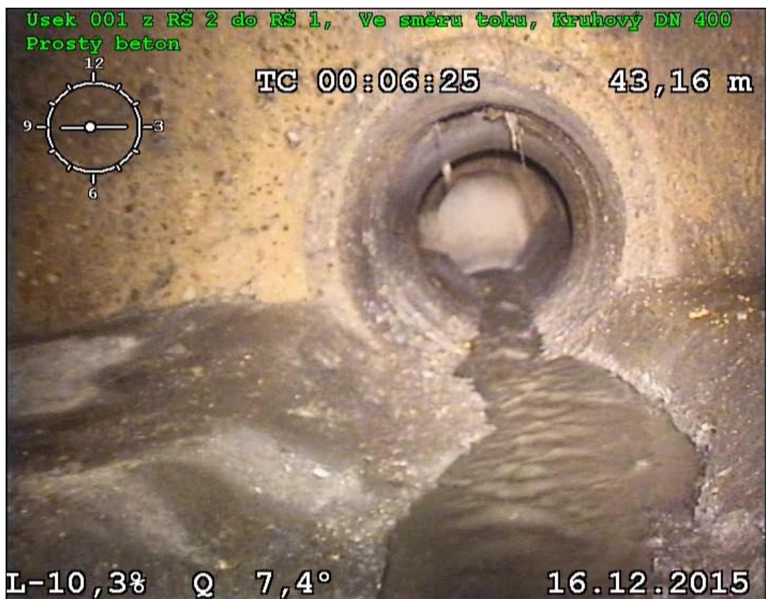
Obrázek 8.14 – Šachta Š1 – poškozené (vymleté) dno v kyněti – DAFIA
