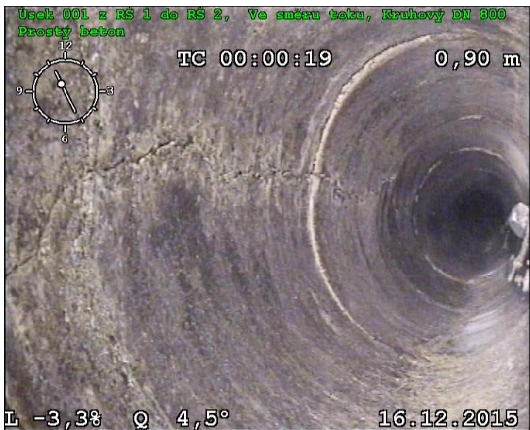
Obrázek 8.16 – Úsek Š1 – Š2, deformace 5%, celý úsek – BAAA, otevřené praskliny – BABCA
