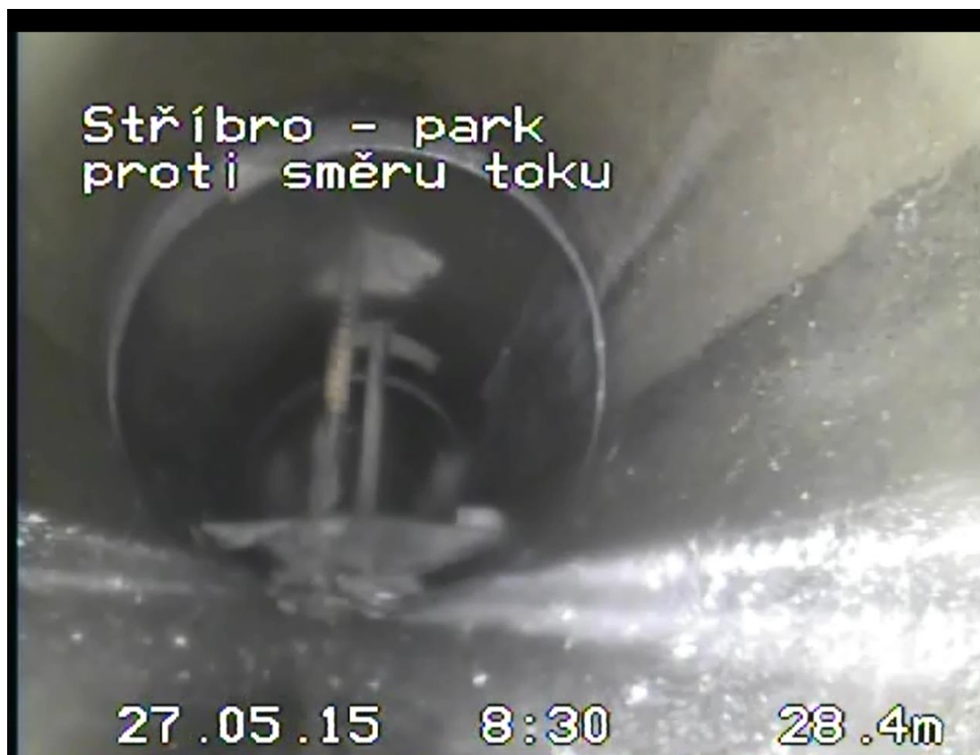
Obrázek 8.19 – Úsek Š1 – Š2, staničení 29,5m, cizí předmět ve stoce - BBEH
