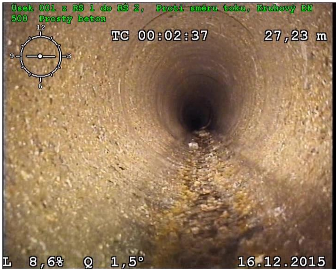
Obrázek 8.11 – Úsek Š1 – Š2, koroze materiálu po celém obvodu, celý úsek – BAFCB
