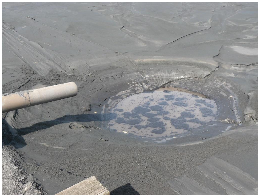
Příloha č. 6 – Vyústění potrubí flotačních kalů do odkaliště NP-1 Paskov (zdroj: autor)
