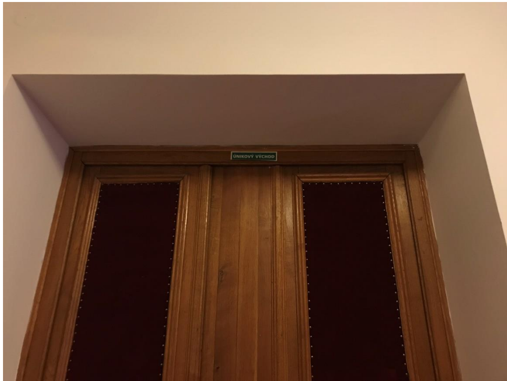
Obrázek 21 Nepřehledné značení únikového východu (Zdroj: Vlastní fotografie)
