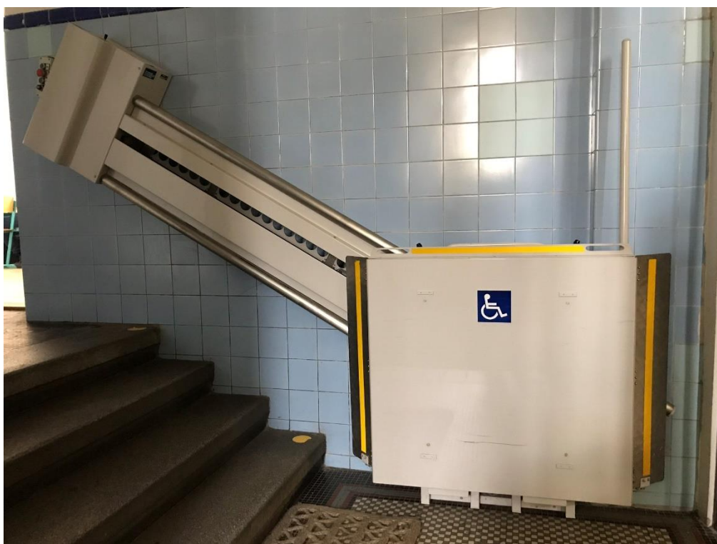
Obrázek 25 Invalidní plošina – vstup do učebny
