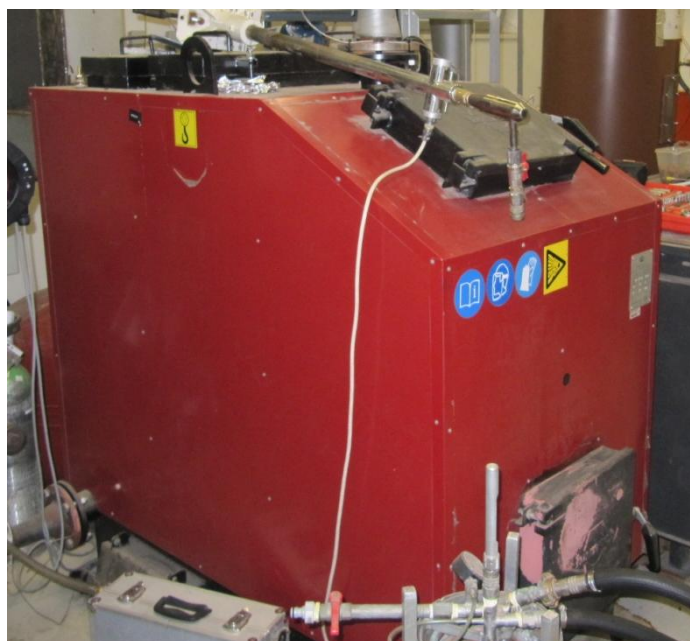
Obrázek 29 Výměník KWH v laboratořích Energetického ústavu FSI
