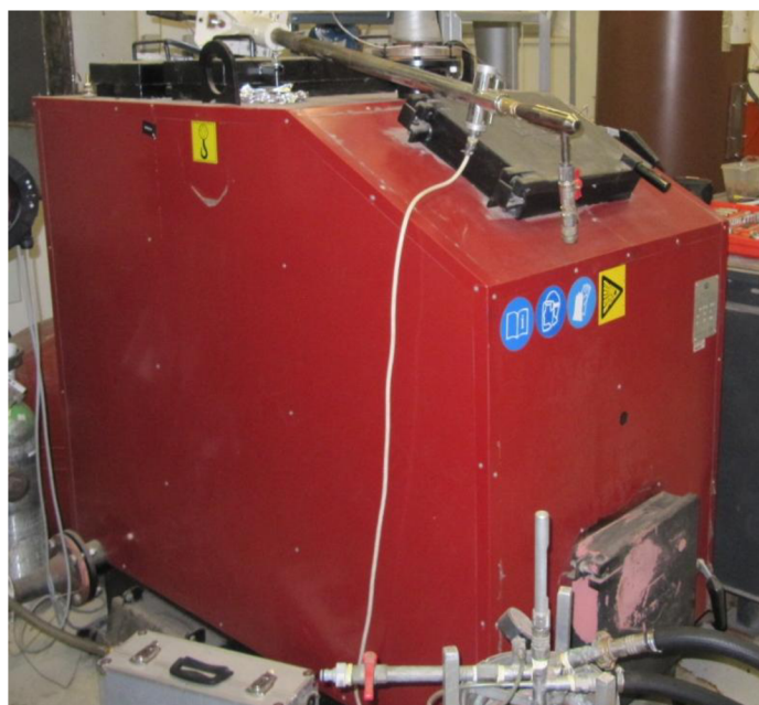
Obrázek 29 Výměník KWH v laboratořích Energetického ústavu FSI
