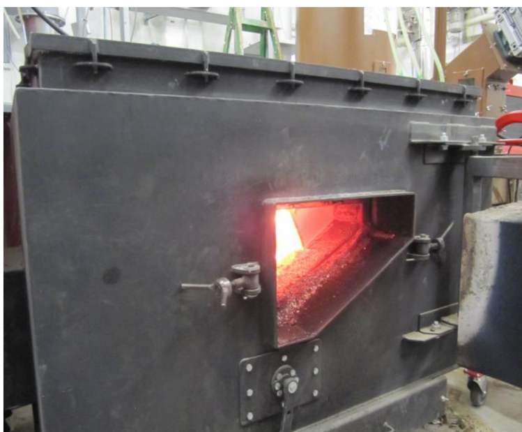
Obrázek 27 Detail zplyňovací komory ZKG
