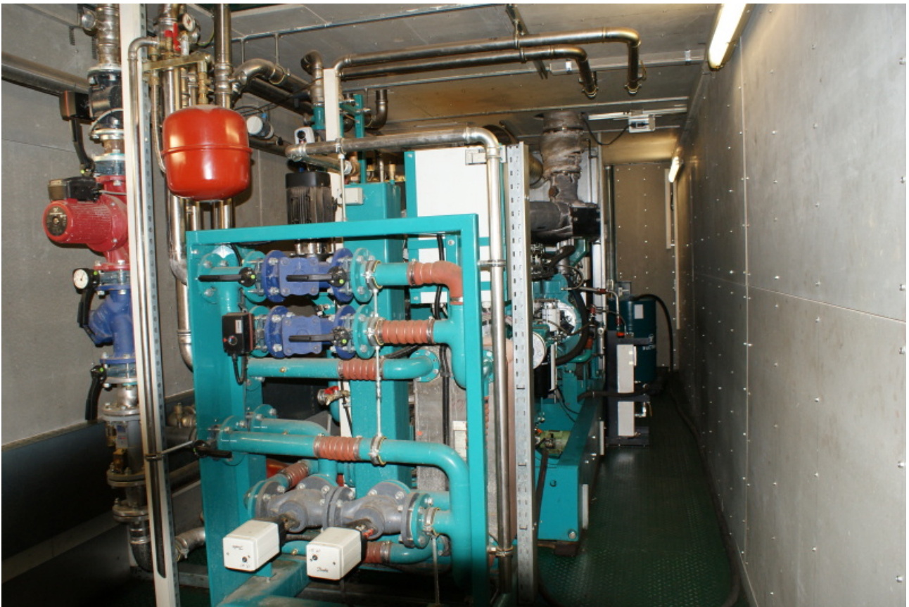
Obr. 29 Kogenerační jednotka Schnell - pohled do kontejneru
