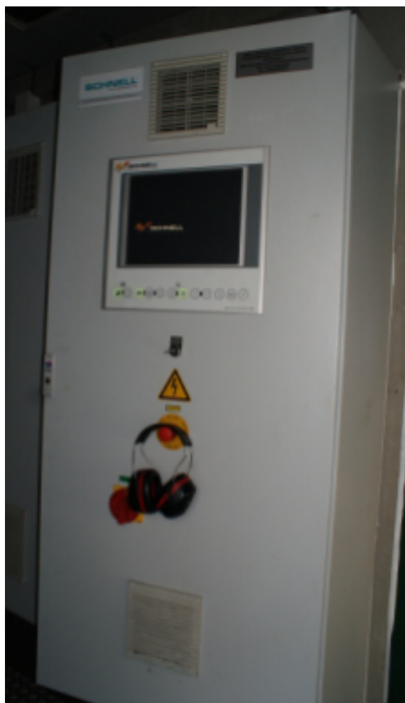
Obr. 31 Řídící panel kogenerační jednotky firmy Schnell
