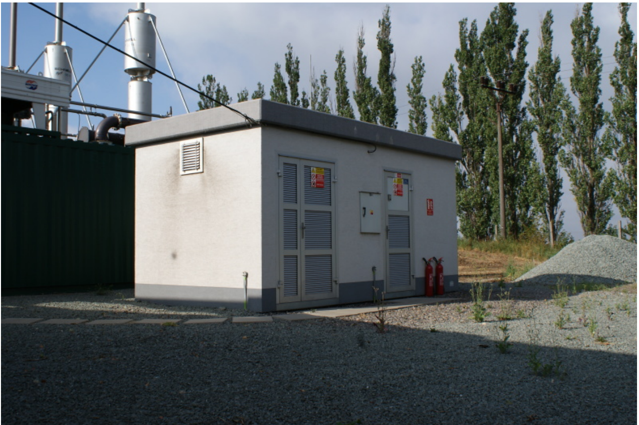
Obr. 33 Trafostanice bioplynové stanice
