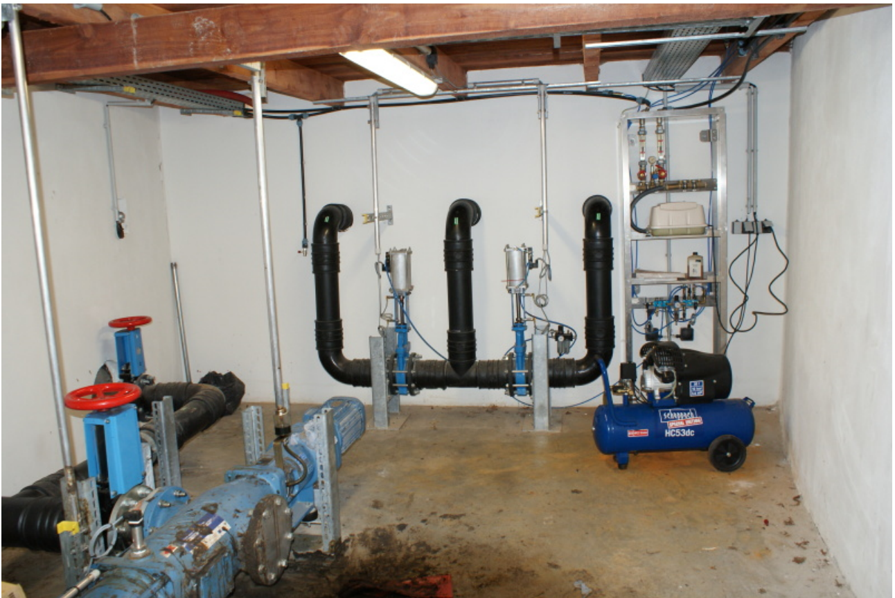
Obr. 18 Dávkořač vzduchu do fermentoru
