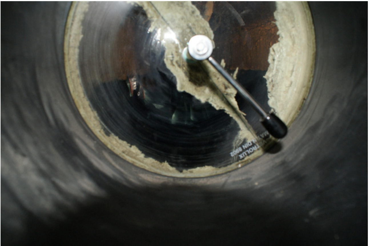
Obr. 20 Kontrolní okénko fermentoru
