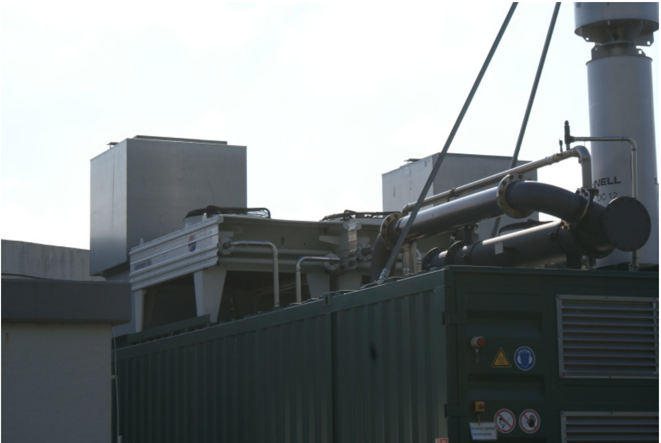
Obr. 32 Chladící zařízení kogenerační jednotky
