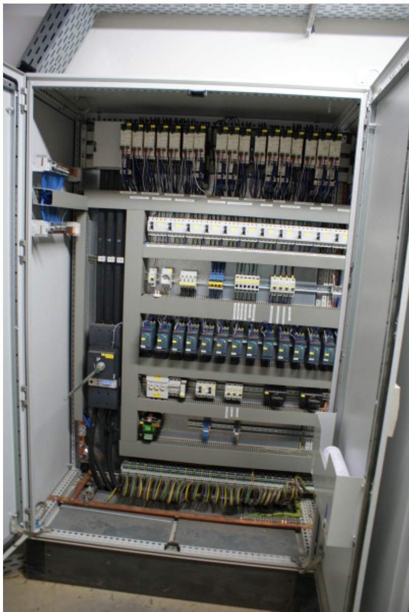
Obr. 27 Elektrický rozvaděč s ovládacími prvky
