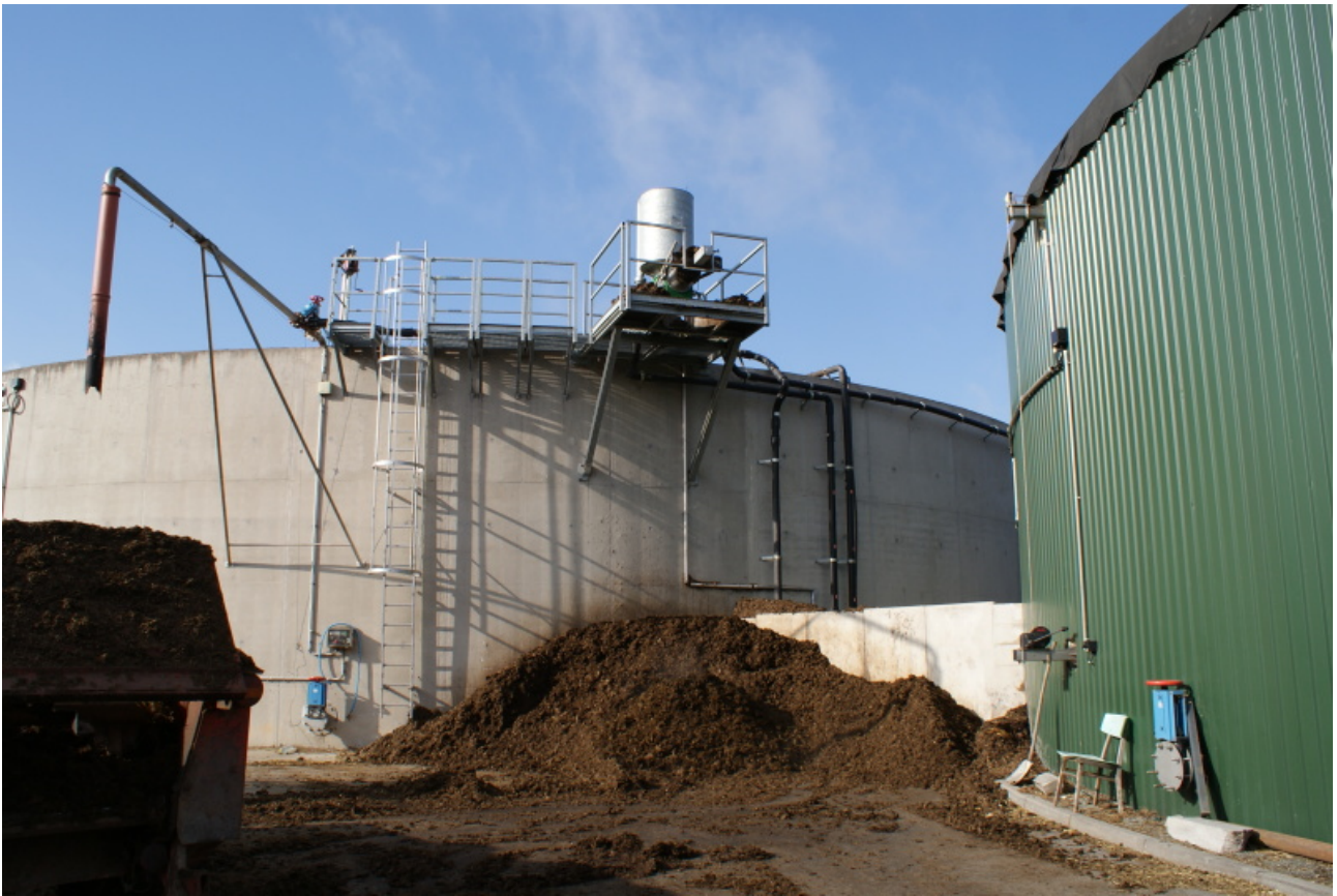
Obr. 36 Otevřená skladovací nádrž se zařízením na oddělování pevné složky digestátu od kapalné
