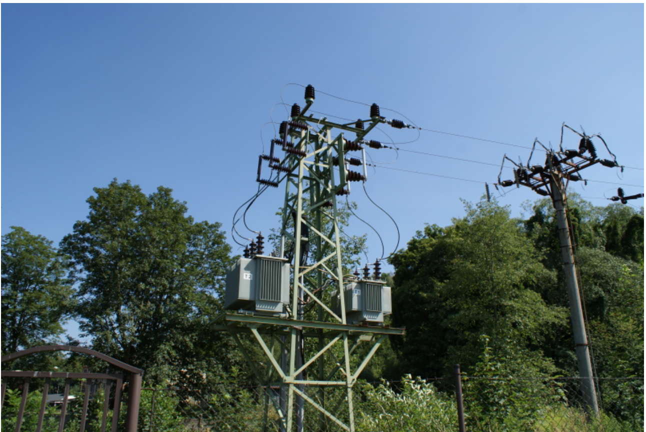
Obr. 29 Trafostanice bioplynové stanice
