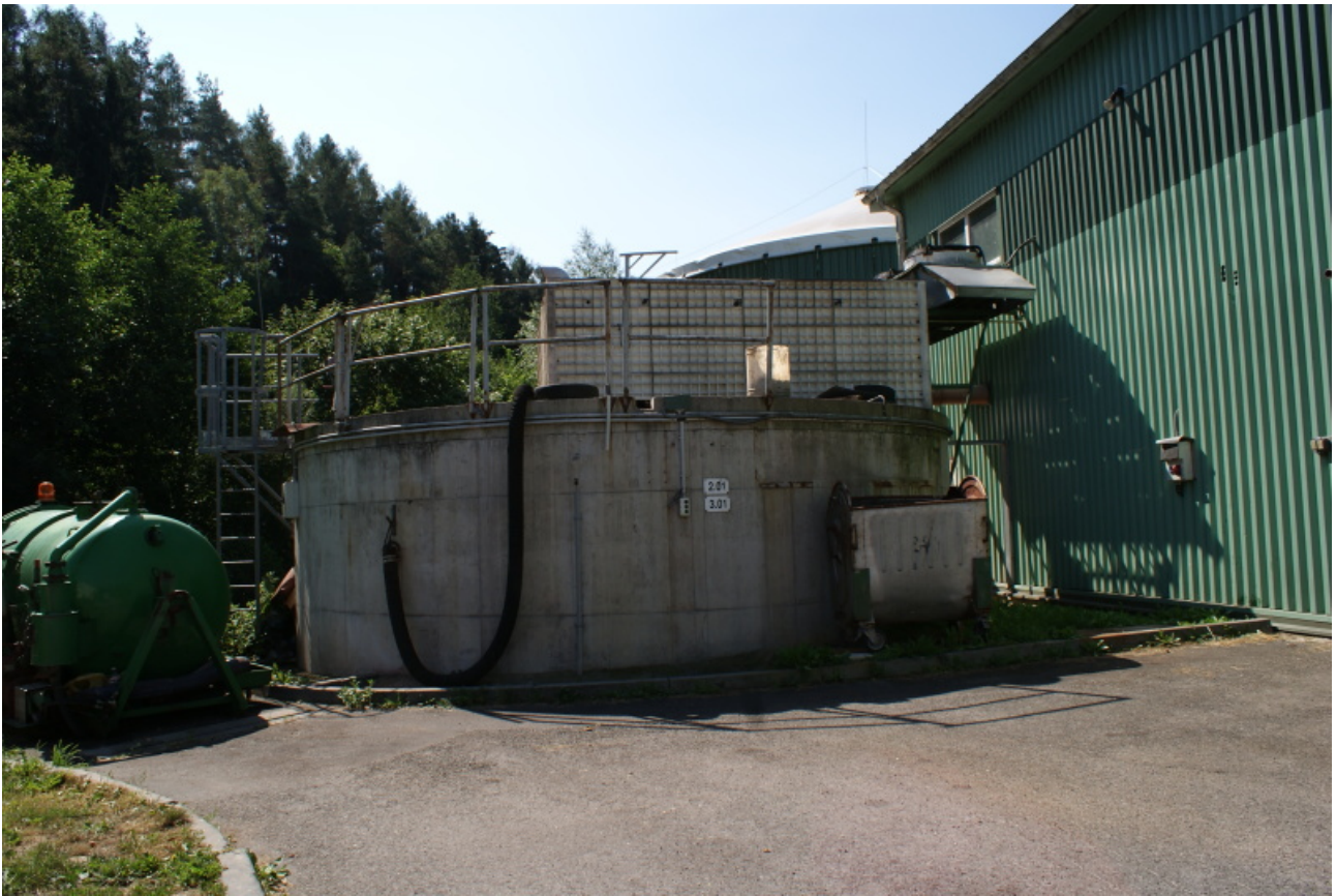
Obr. 7 Vstupní nádoba na odpad
