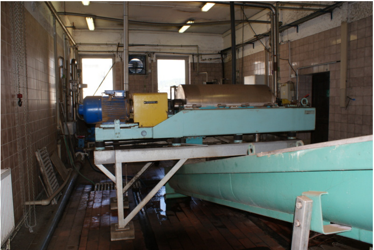
Obr. 34 Zařízení na oddělování pevné a kapalné složky ze skladovací nádrže
