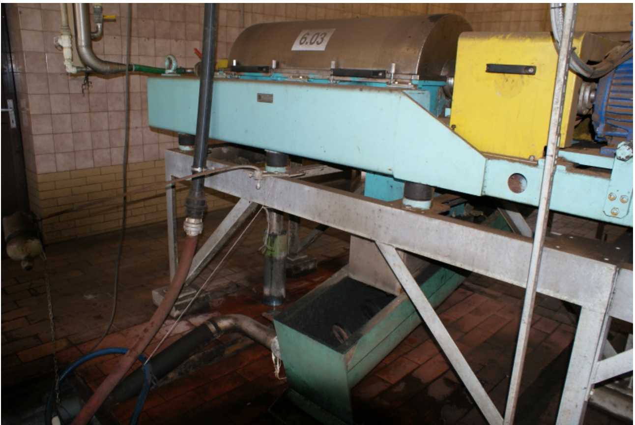
Obr. 35 Pohled na oddělovací zařízení
