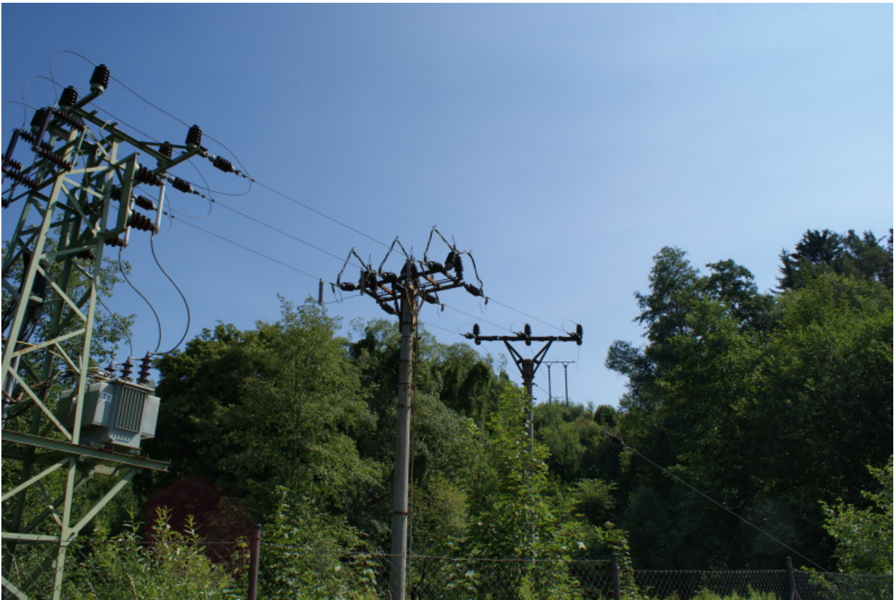
Obr. 30 Vedení vysokého napětí od a do bioplynové stanice
