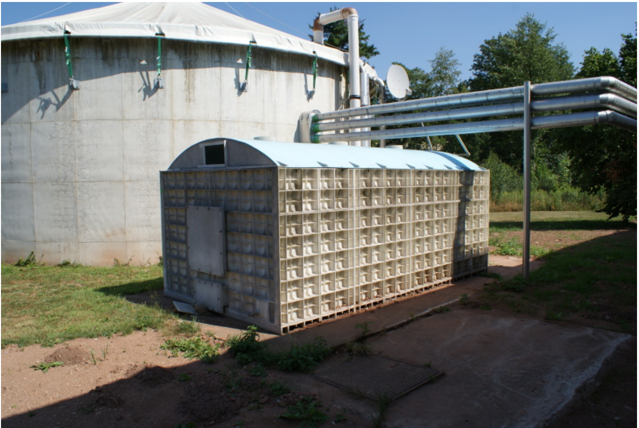
Obr. 32 Pachový filtr skladovací nádrže
