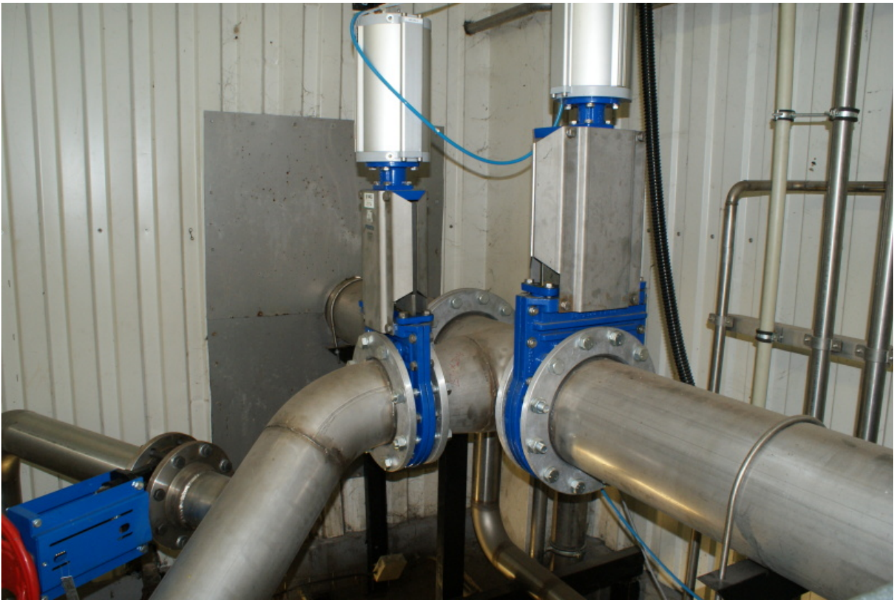
Obr. 14 Směšovací ventily odpadu, řízené pomocí řídicí jednotky
