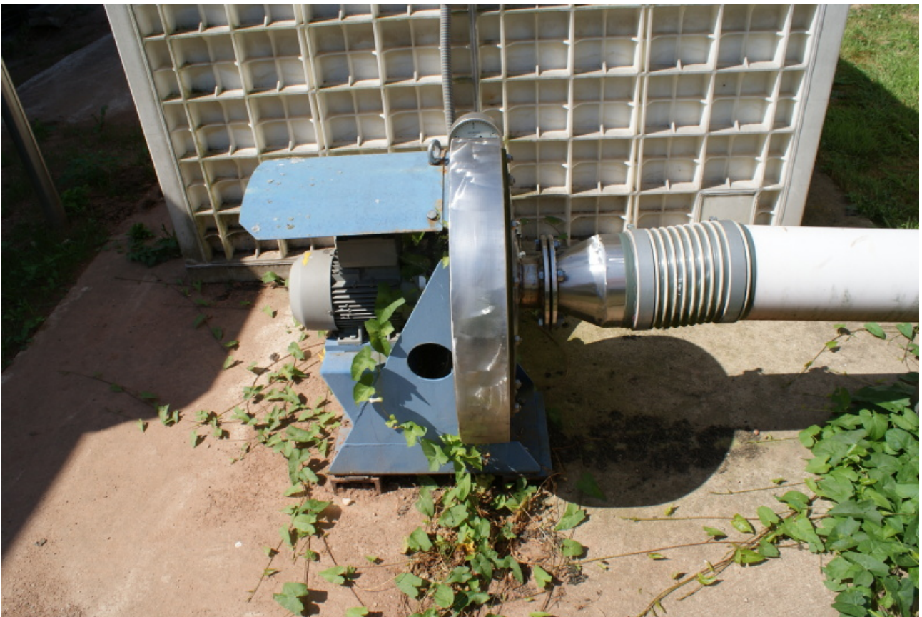
Obr. 33 Kompresor na vhánění vzduchu do filtru z dřevní štěpky ze skladovací nádrže
