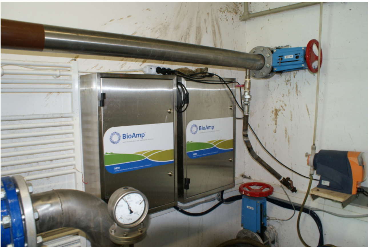
Obr. 15 Zařízení na podporu dávkování bakterií do fermentoru
