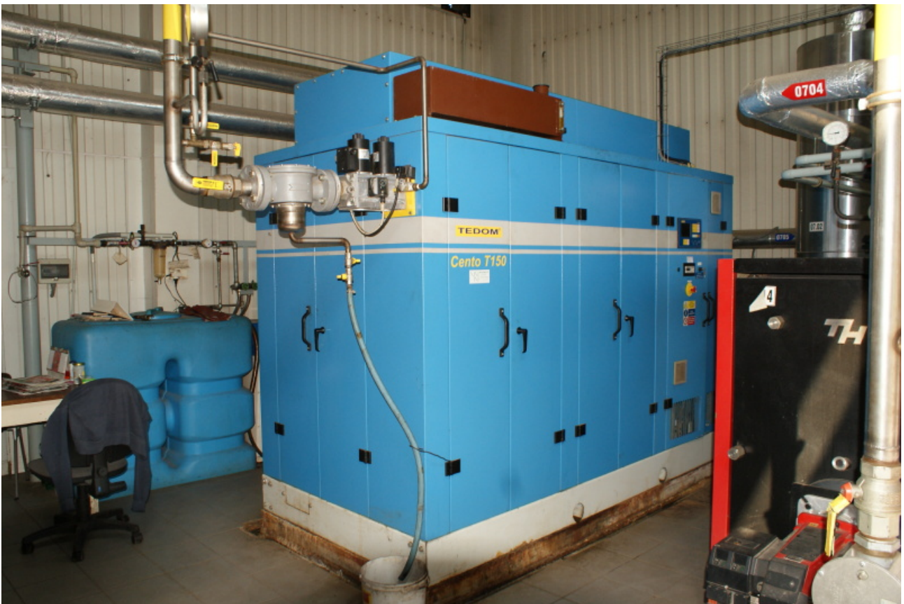
Obr. 23 Zakrytovaná kogenerační jednotka od firmy TEDOM
