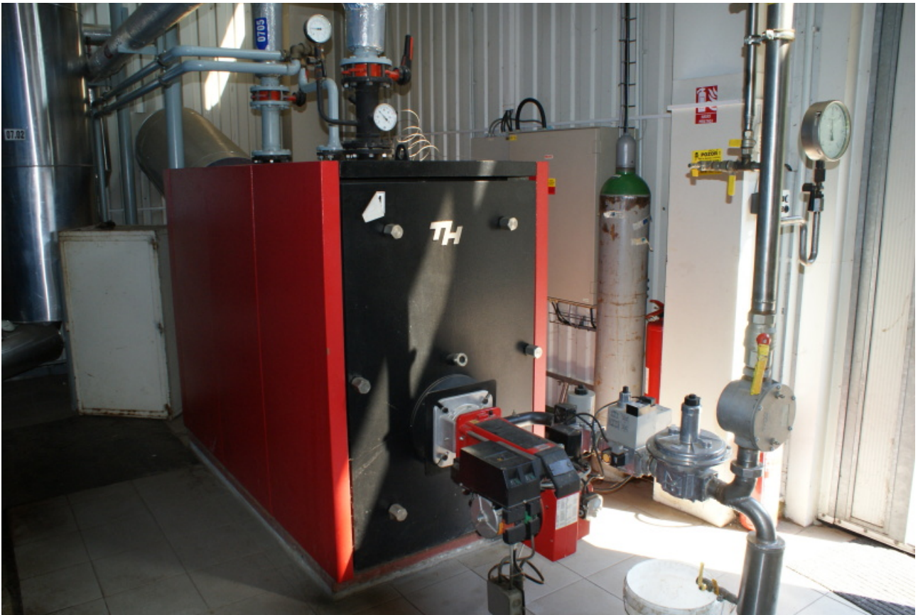
Obr. 26 Záložní kotel na spalování bioplynu
