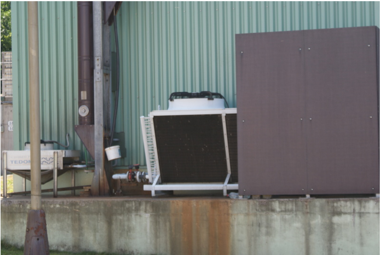
Obr. 28 Venkovní chladící zařízení kogenerační jednotky
