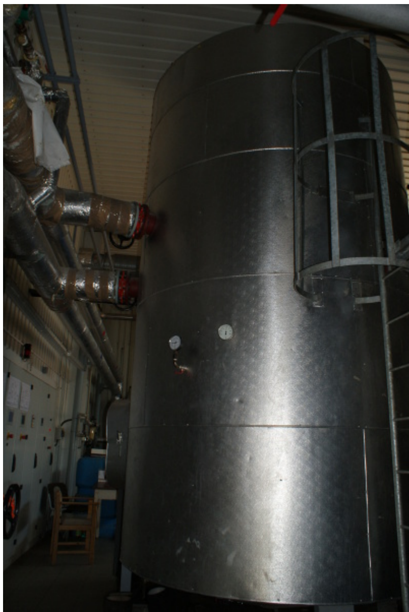
Obr. 17 Druhá pasterizační nádoba, vlevo v rohu dvě trubka na vytápění budovy ze zbytkového tepla
