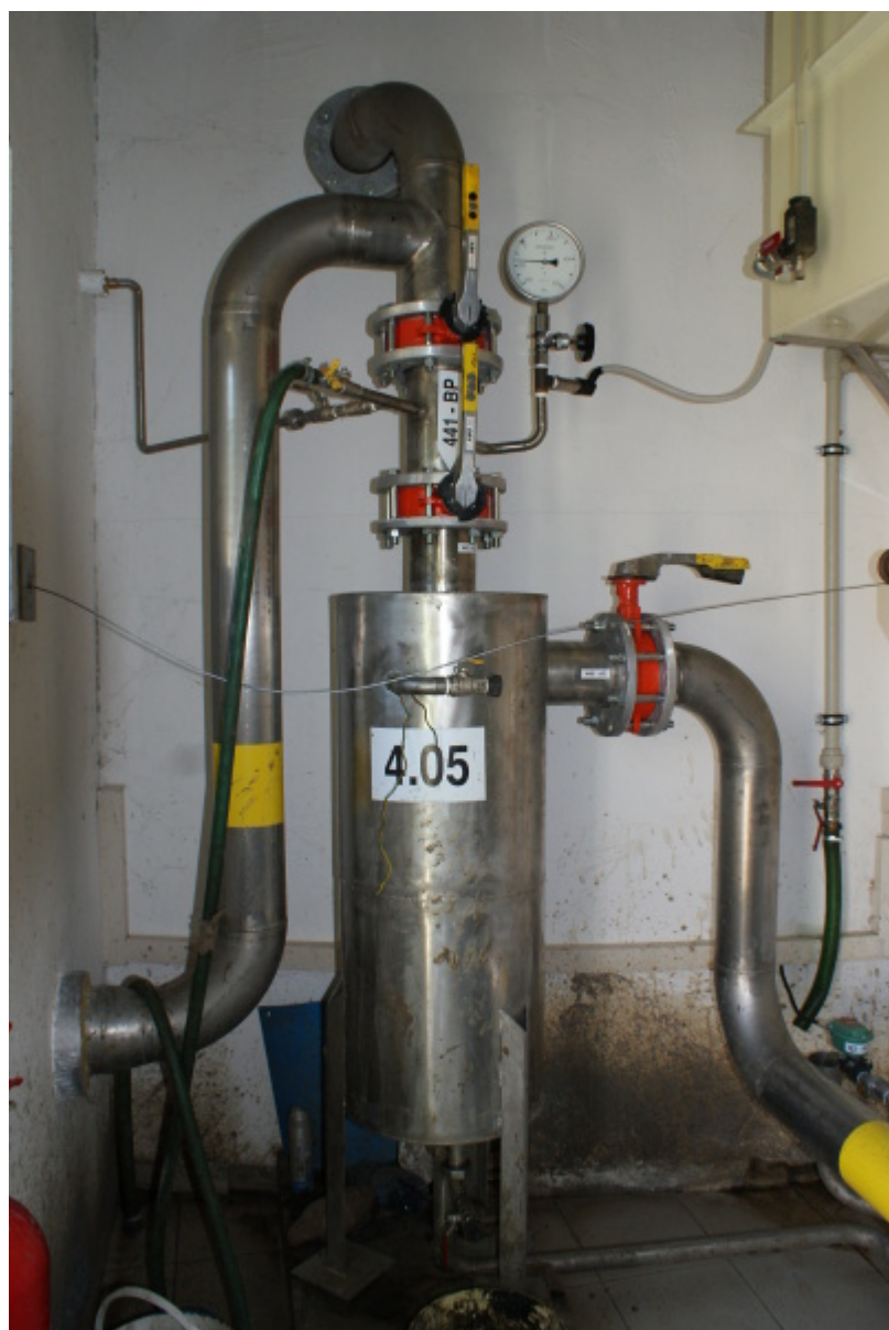
Obr. 21 Bezpečnostní uzávěr jímaného plynu z fermentoru
