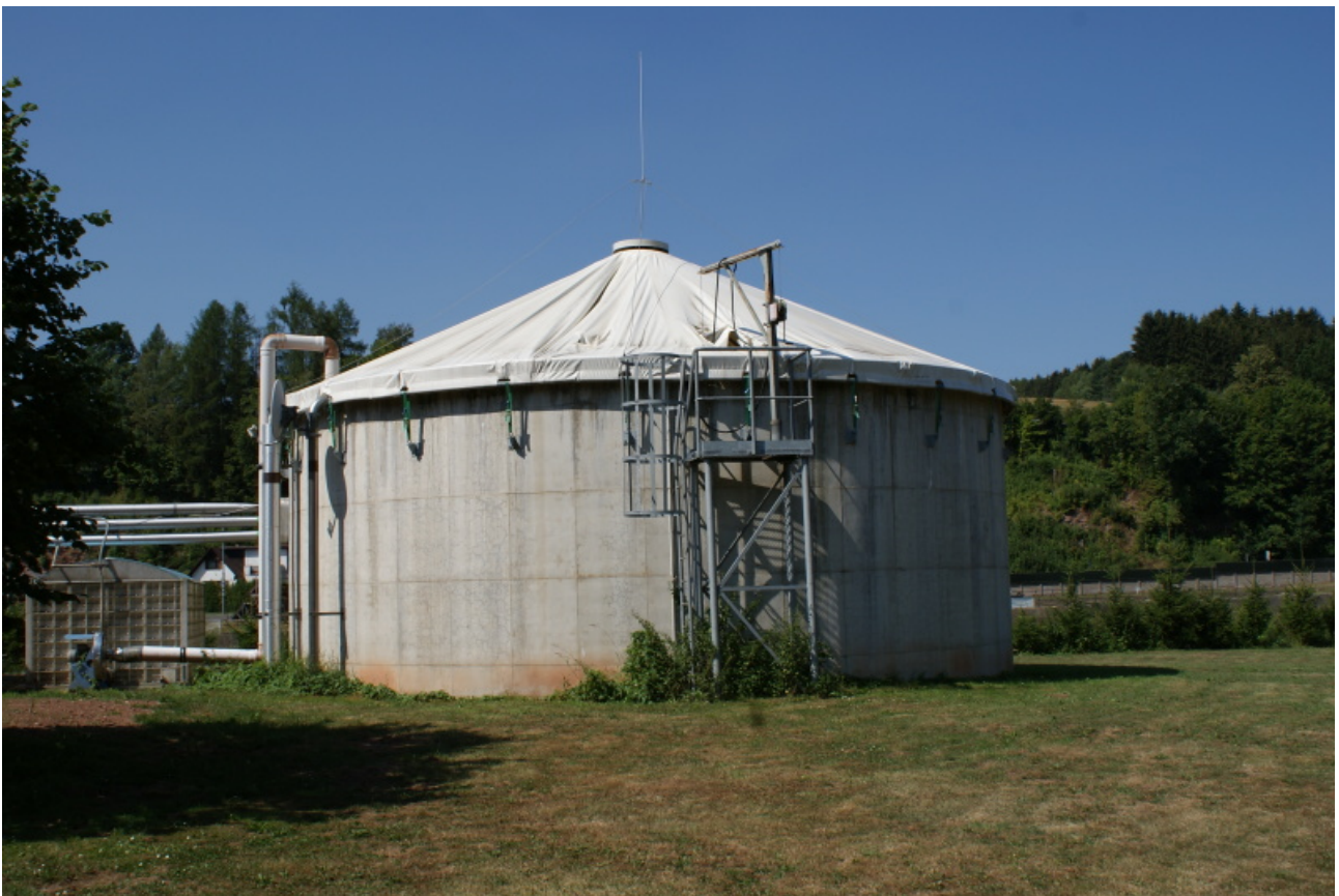
Obr. 31 Skladovací nádrž bioplynové stanice
