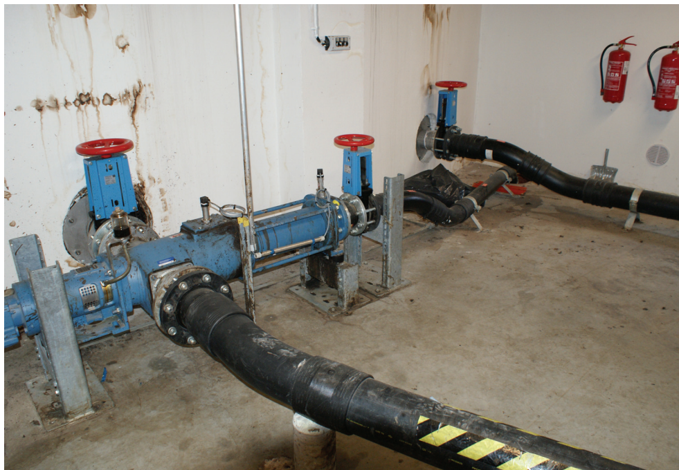
Obr. 22 Potrubí na substrát
