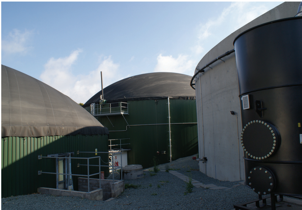
Obr. 17 Skladovací nádrž s bezpečnostním ventilem
