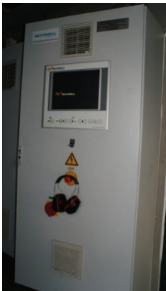
Obr. 33 Řídící panel kogenerační jednotky firmy Schnell
