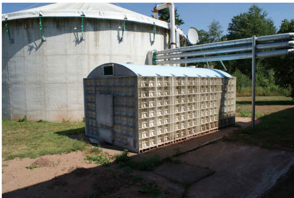
Obr. 45 Filtr s vlhčenou dřevní kůrou
