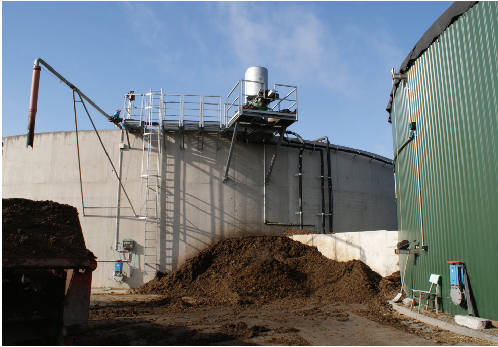
Obr. 18 Otevřená skladovací nádrž se zařízením na oddělování pevné složky digestátu od kapalné
