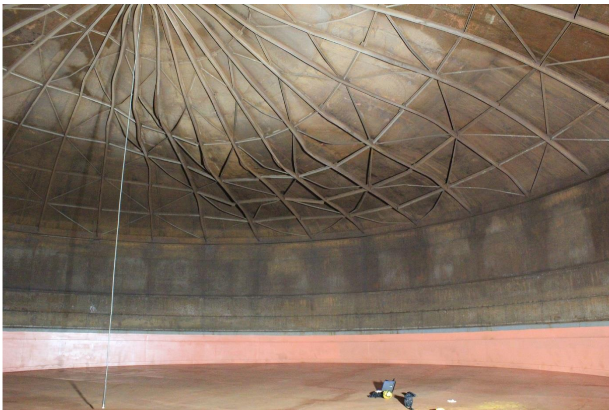
Obr. 3.3 Zdeformovaná nádrž ve Včelné - vnitřní pohled
