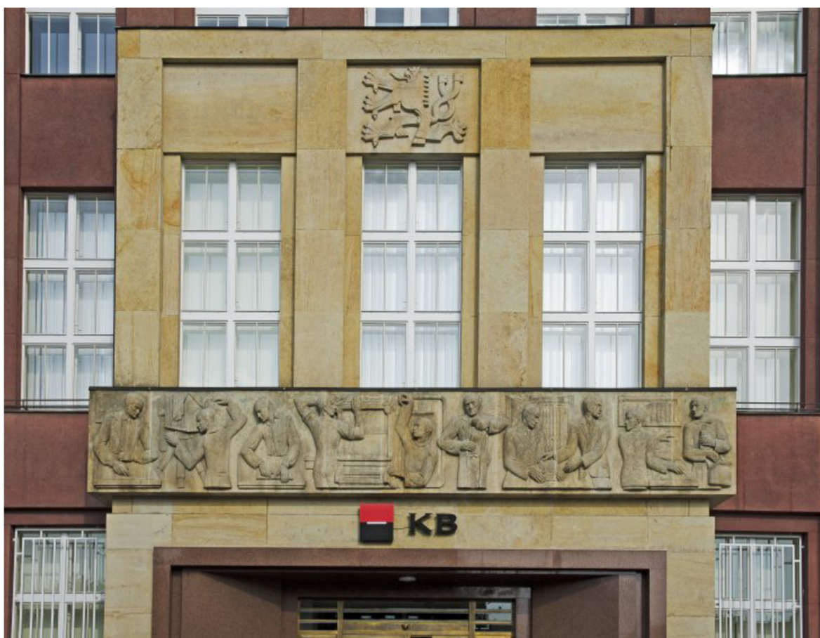
Obrázek č. 29, Současný stav reliéfu dle návrhů Josefa Václava Škody, autor fotografie: Jiří Zikmund 2018.
