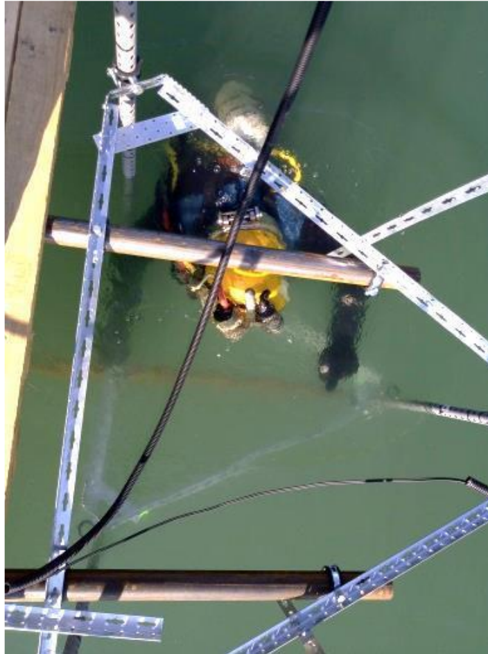
Obr. 39 Fixace čidel pod vodní hladinou [19]
