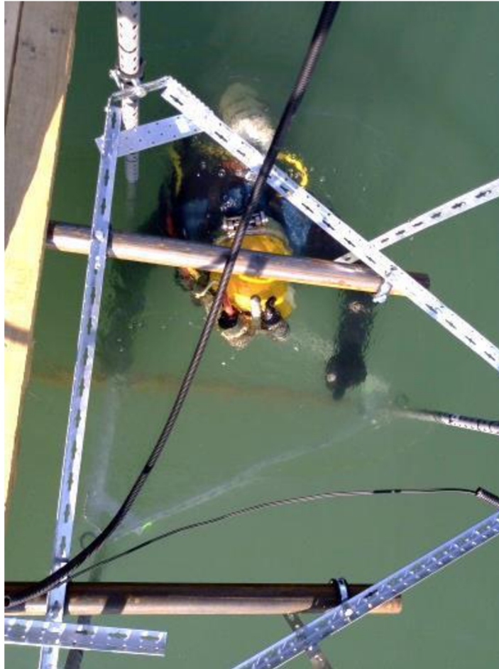
Obr. 39 Fixace čidel pod vodní hladinou [19]
