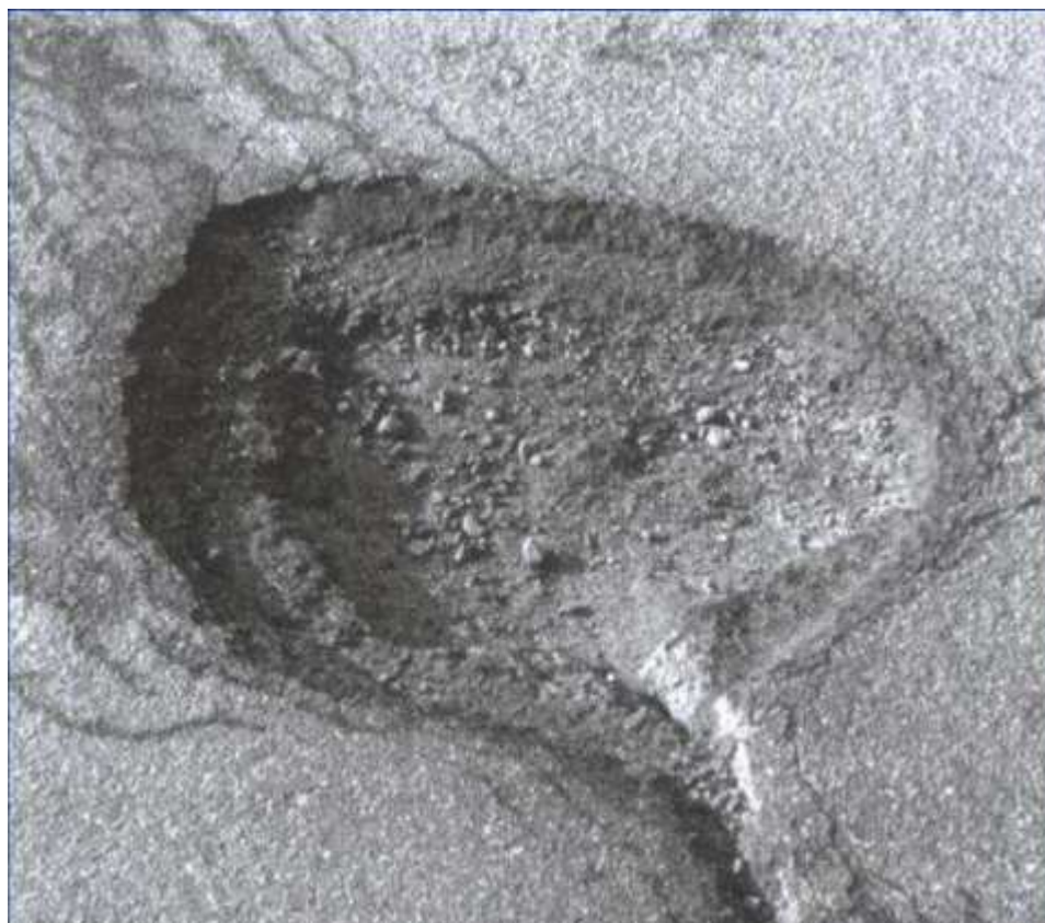
Obr. 31 Příklad ztráty mikrotextury na vozovce [32]
