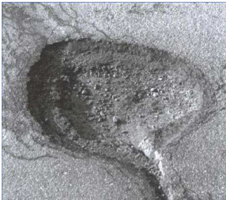
Obr. 31 Příklad ztráty mikrotextury na vozovce [32]
