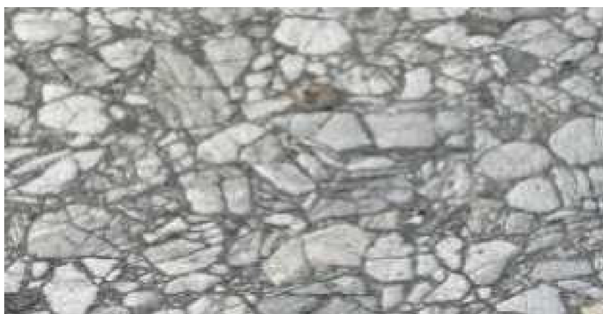
Obr. 30 Příklad ztráty mikrotextury na vozovce [25]
