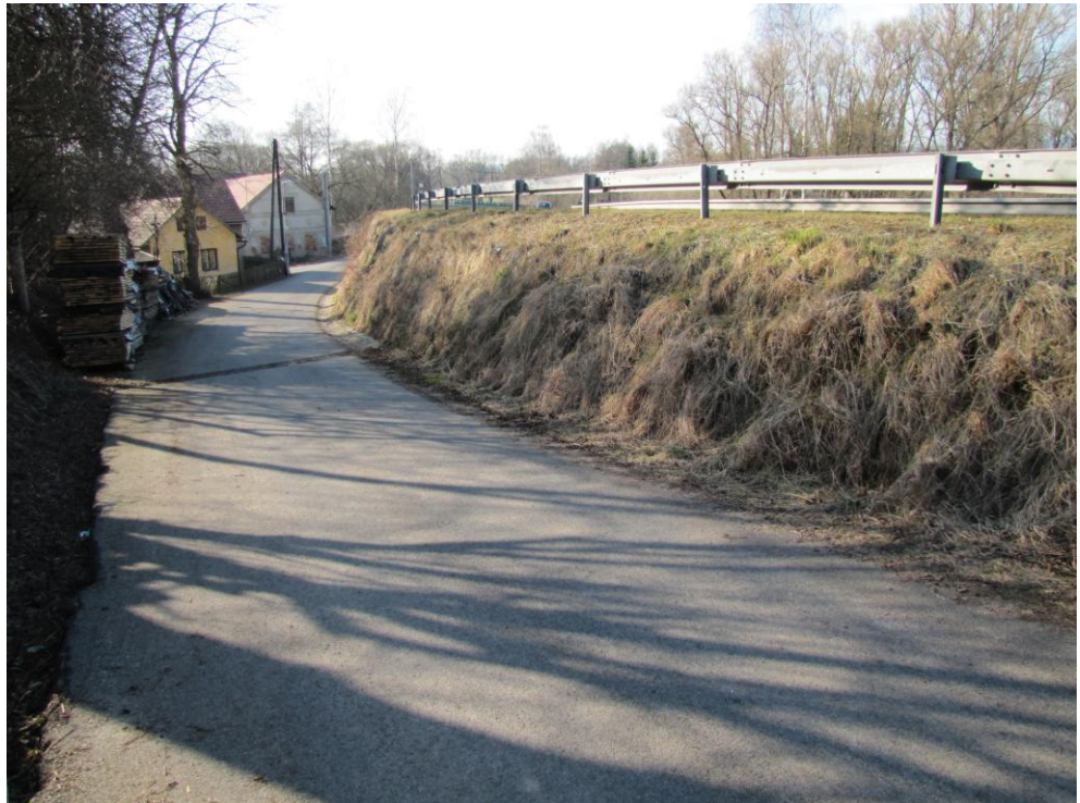
Obr. 21 Směrový oblouk na návodní straně, aktuální stav
