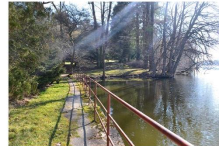
4. DEGRADUJÍCÍ VYBETONOVANÁ HRANICE PEVNINY S RYBNÍKEM POD NÁDVORÍM
