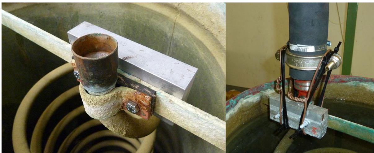
Obr. 22 Detail vstupního hrdla a detail napojení parní hadice na kondenzátor
