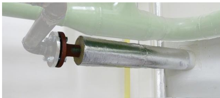
Obr. 13 Vyústění parního potrubí v laboratoři
