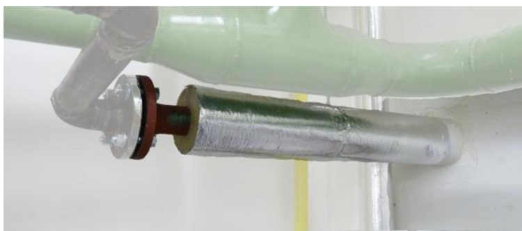
Obr. 13 Vyústění parního potrubí v laboratoři
