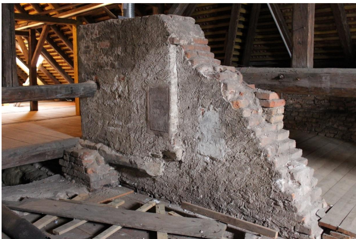
Stržený komín v severním křídle.
