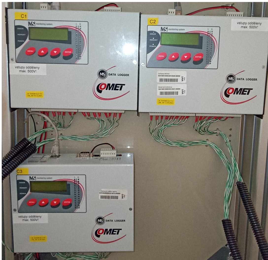
Obr. 6.3: Detail měřicích ústředěn
