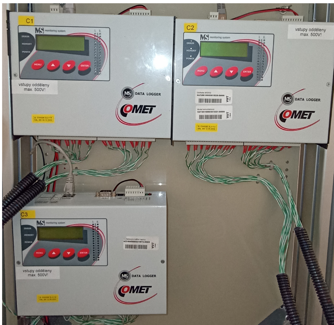
Obr. 6.3: Detail měřicích ústředěn
