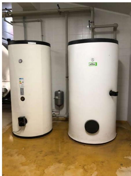
Obrázek 45 - Boiler (vlastní foto)
