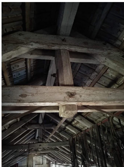
Obrázek 16 Krov ve Vřestudech: Patrné zbytky vápenného nátěru a zdobení sloupku, foto archiv autora
