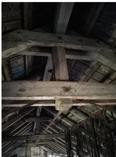
Obrázek 16 Krov ve Všetudech: Patrné zbytky vápenného nátěru a zdobení sloupku, foto archiv autora
