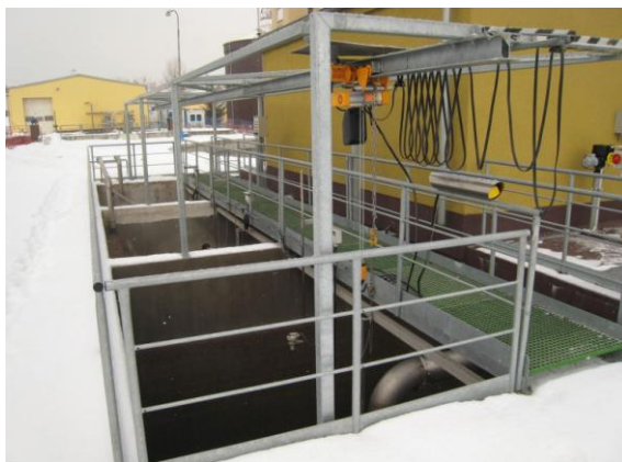
Foto 3: Kalové jímky [Krejčí, 2010].
