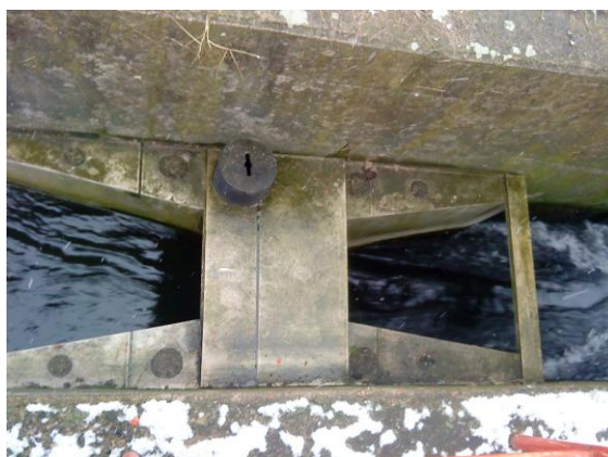
Foto 10: Parshallův žlab na odtoku [autor].
