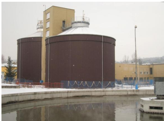
Foto 6: Vyhňivací nádrže [Krejčí, 2010].
