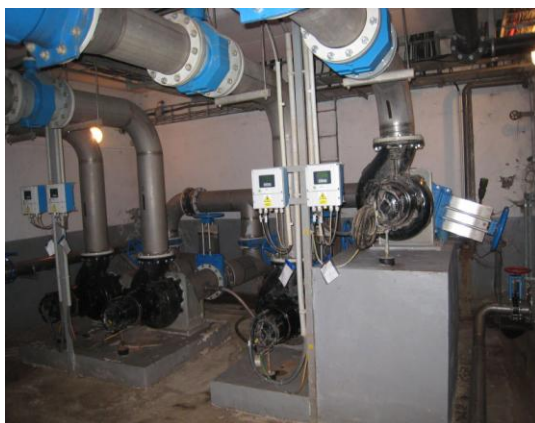
Foto 8: Čerpadla vratného kalu [Krejčí, 2010].
