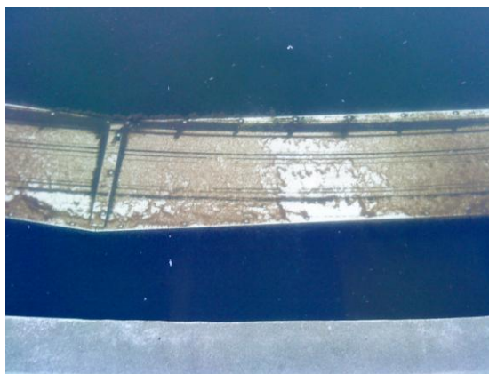
Foto 9: Zanořené potrubí v dosazovací nádrži [autor].
