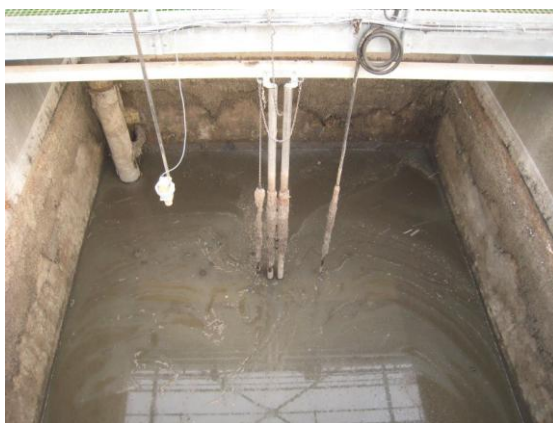
Foto 4: Jímka primárního kalu [autor].
