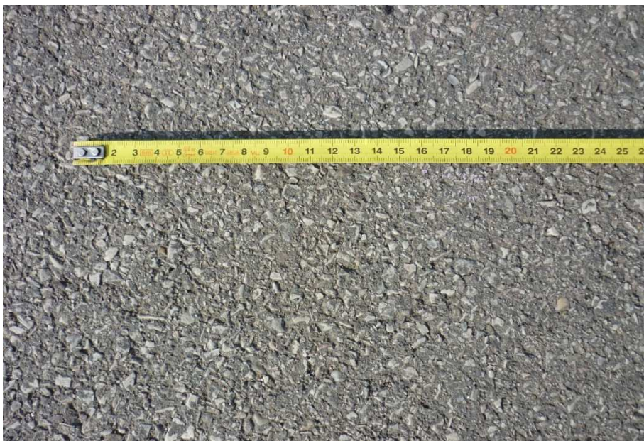
Obr. č. 7.16 – Asfaltový povrch na zpevněné ploše mezi obcemi Kobylice a Králíky [autor]
