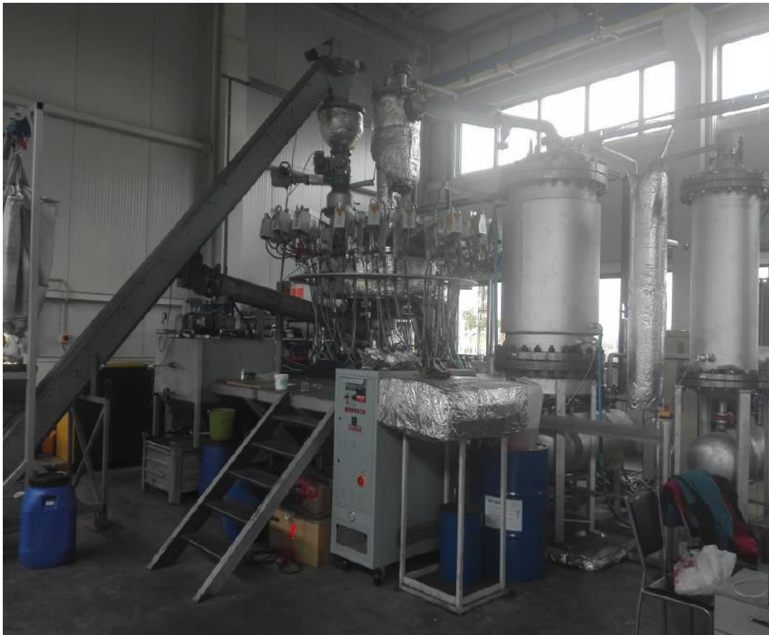
Obrázek č. 7 Velká provozní jednotka mikrovlnné pyrolýzy umístěná ve výzkumném středisku AdMaS (Radim Šimek)
