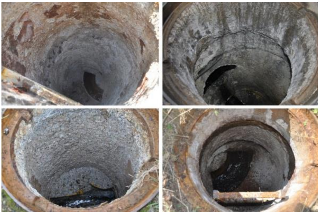
Obr. 8 – Biogenními kyselinami zdegradovaný beton na bázi OPC v kanalizačním systému [18]
